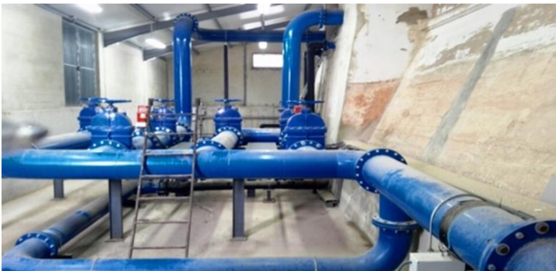
Ilustración 5: Entrada de agua al depósito
