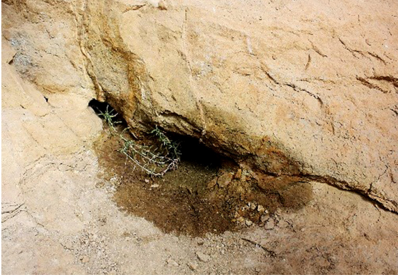
Figura 9. Filtració continuada d'aigua que genera arenització i pulverulència en el suport (Barreda, 2012).
