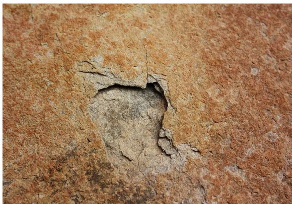
Figura 23. Formació de esbombaments i posterior despreniment del material petri (Barreda, 2012).
