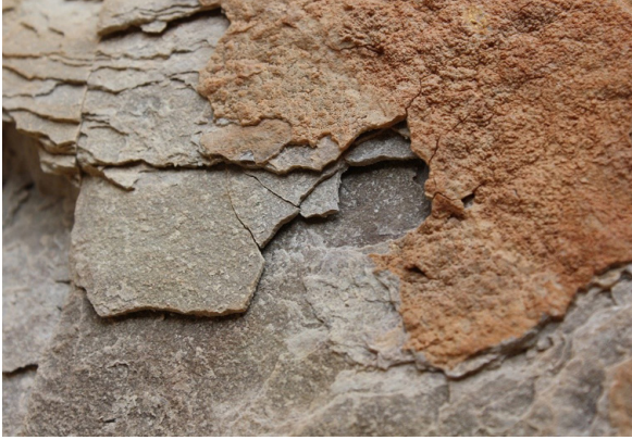
Figura 13. Disjunció de la superfície en forma de deplacat (Barreda, 2012).
