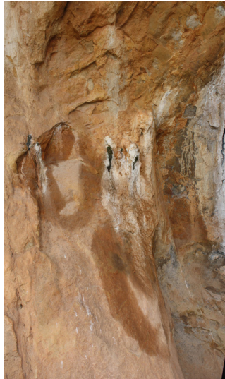
Figura 18. Filtració d'aigua de pluja a través de les fissures de la roca (Barreda, 2012).
