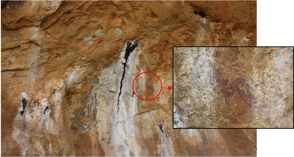
Figura 22. Vessaments de carbonat càlcic que afecten directament les figures representades (Barreda, 2012).
