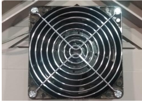
Figura 5.44 Ventilador atornillado en la caseta
