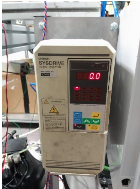
FIGURA 3.7. VARIADOR DE FRECUENCIA.
