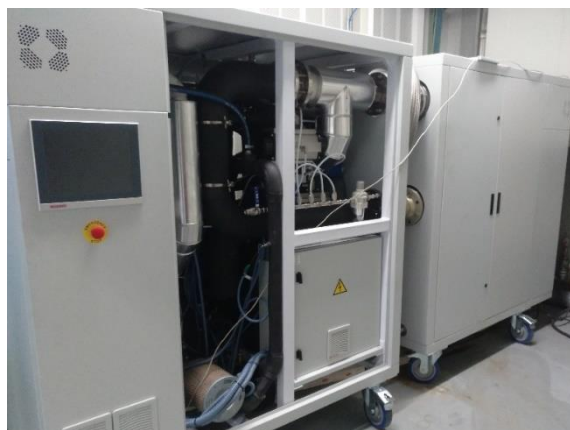
Figura 7. Acondicionador de Temperatura (izquierda) y Humectador (derecha).
