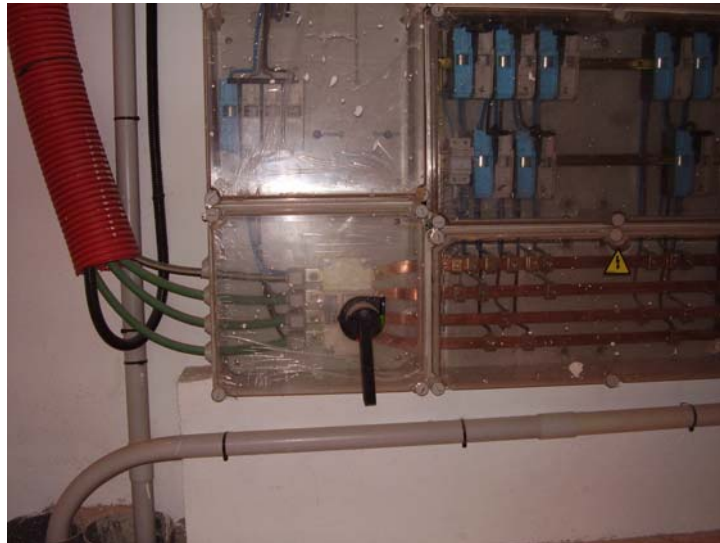
Fotografía 1: Tramo final de una LGA en el punto de conexión con el panel de contadores. Realizada por los autores.
