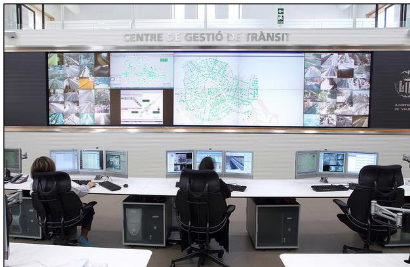
Figura 3. Sala de Control de Tráfico de Valencia
