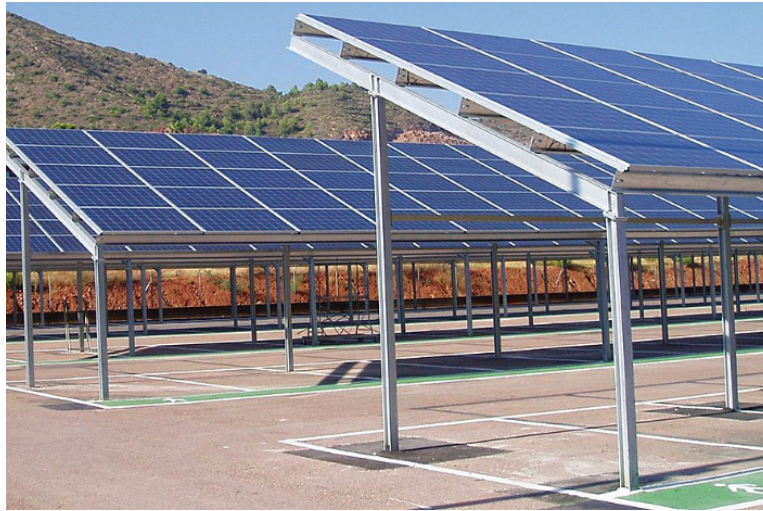
Ilustración 39: Ejemplo marquesinas en parking con paneles solares [66]
