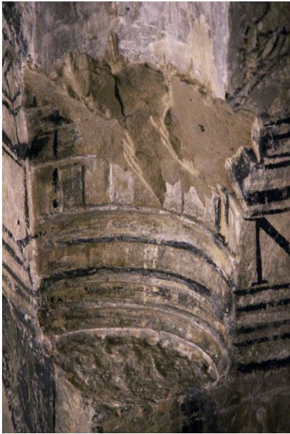
Figura 48. Detalle del estado de uno de los capiteles.
