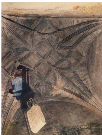
Figura 16. Estado de la bóveda rota para bajar las pesas del reloj.
