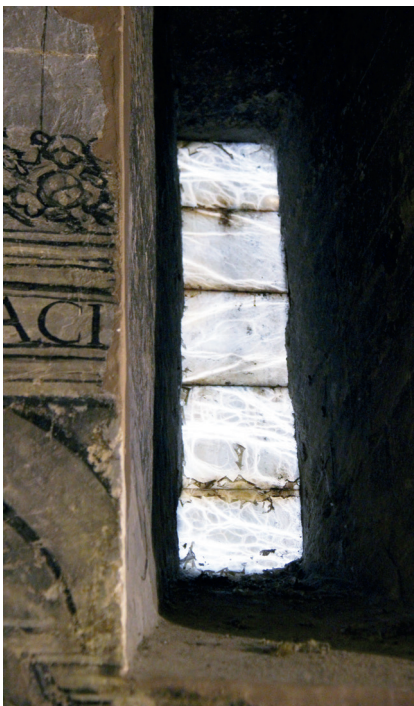
Figura 50. Estado del alabastro actual de la ventana.
