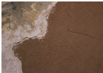
Figura 36. Detalle del estado de los morteros.
