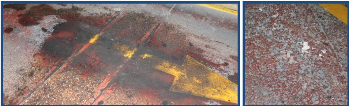
Fotografías 4.17 y 4.18 Daños en el pavimento (fuente: elaboración propia).
