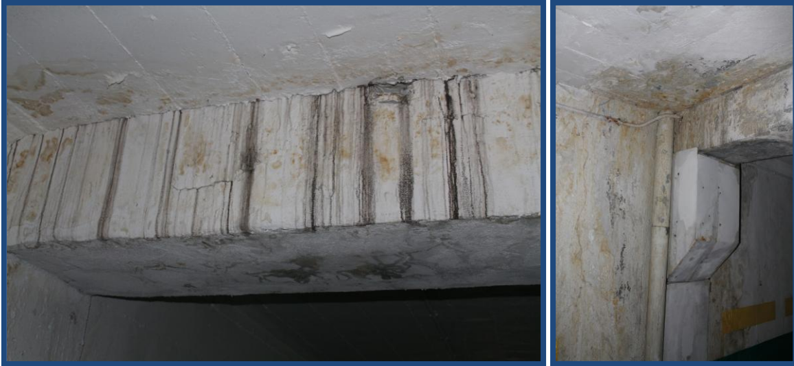
Fotografías 4.6 y 4.7 Humedades en las juntas del forjado y en los muros (fuente: elaboración propia).
