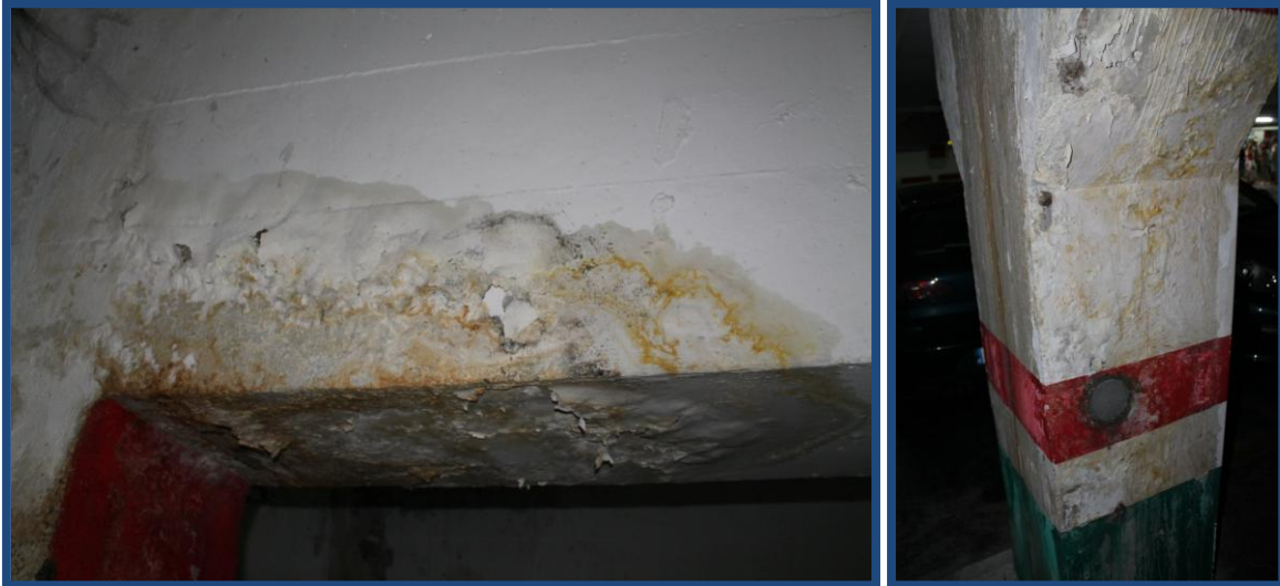
Fotografías 4.3 y 4.4 Viga y pilar afectados gravemente por la humedad (fuente: elaboración propia).
