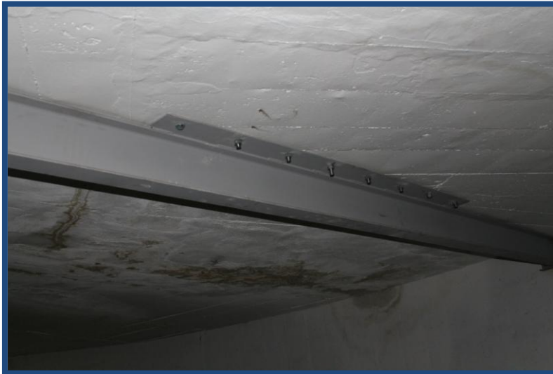
Fotografía 4.16 fisuras y vigas de acero en las rampas (fuente: elaboración propia).
