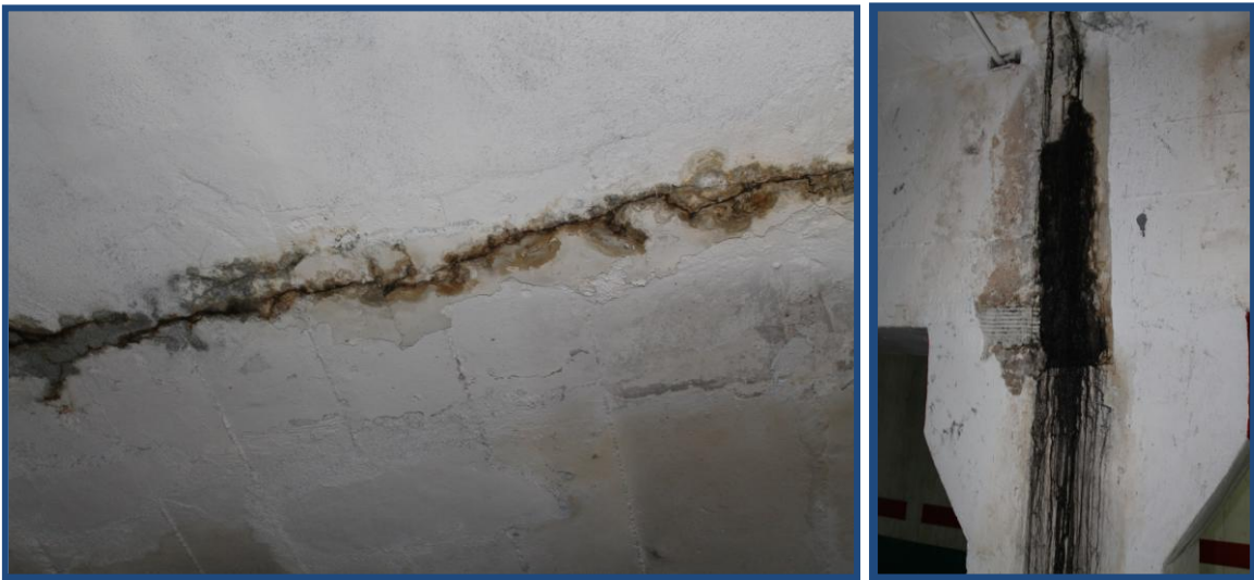
Fotografías 4.1 y 4.2 Humedades en las juntas del forjado y en los pilares (fuente: elaboración propia).
