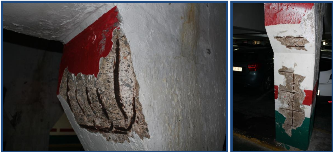
Fotografías 4.8 y 4.9 Pérdida de recubrimiento en las ménsulas y pilares (fuente: elaboración propia).
