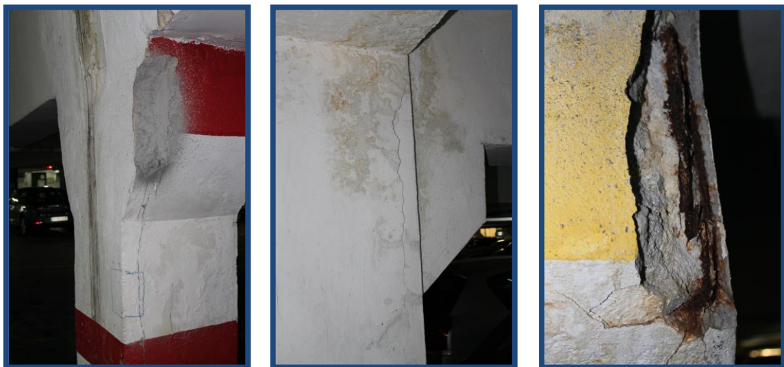
Fotografías 4.10, 4.11 y 4.12 Pérdida de recubrimiento y fisuras en las esquinas de las ménsulas y pilares (fuente: elaboración propia).
