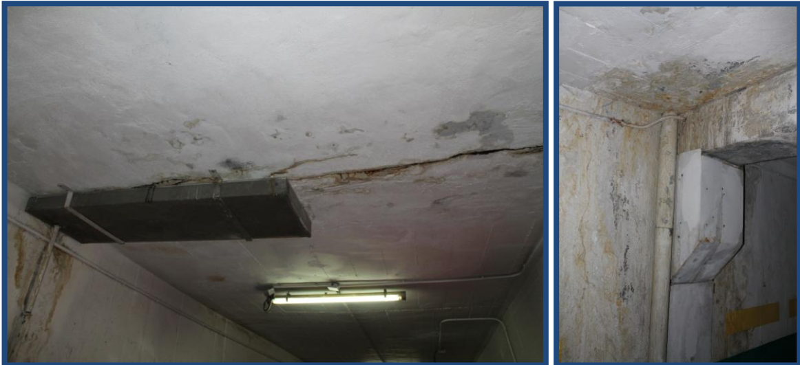
Fotografías 4.13 y 4.14 Humedades en las juntas del forjado de la primera y segunda planta respectivamente (fuente: elaboración propia).
