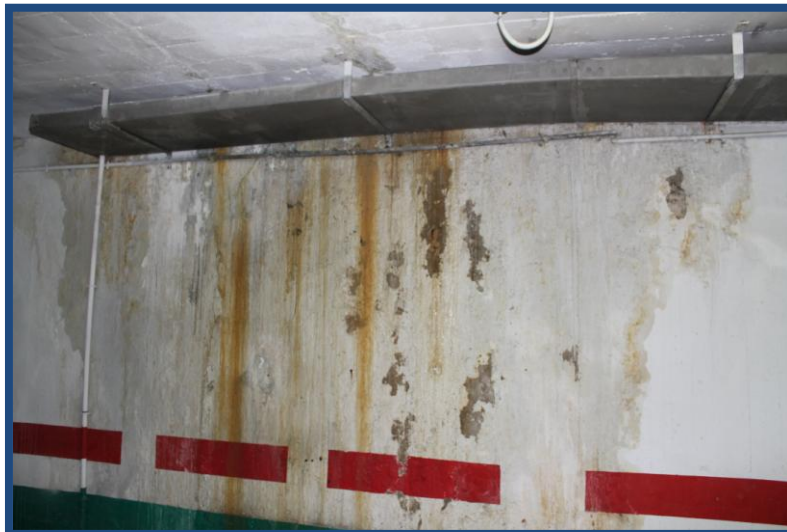
Fotografía 4.5 muro perimetral con humedad (fuente: elaboración propia).
