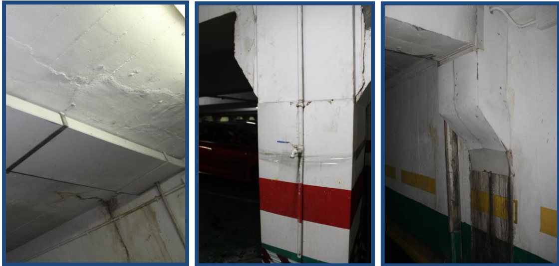
Fotografías 4.19, 4.20 y 4.21 Chapas metálicas ocultando las humedades (fuente: elaboración propia).
