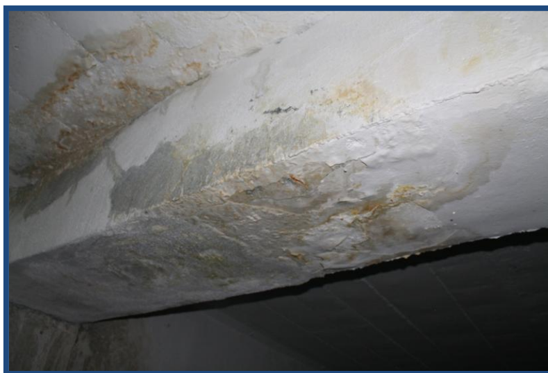
Fotografía 4.15 humedades en las vigas de atado (fuente: elaboración propia).
