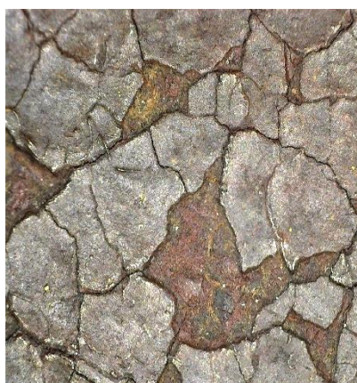
Fig.38. Detalle de craqueladuras y desprendimiento de la pintura.
