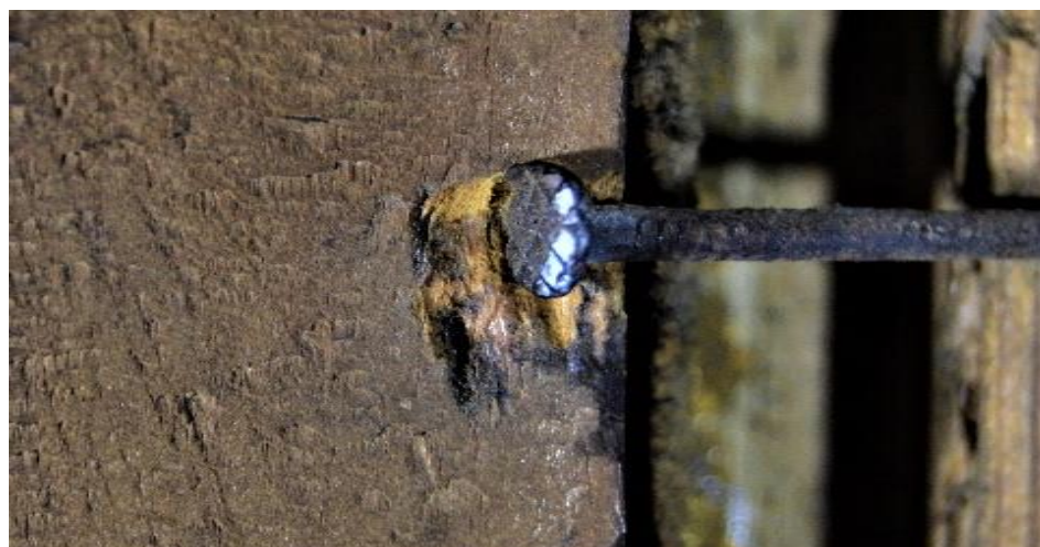
Fig.35. Fotografía de detalle de erosión producida por un clavo.
