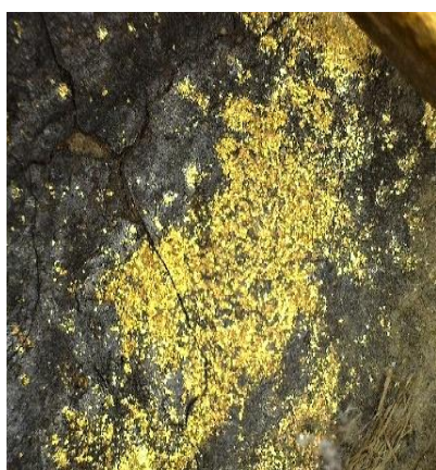
Fig.39. Detalle de una mancha producida por la pintura del marco.
