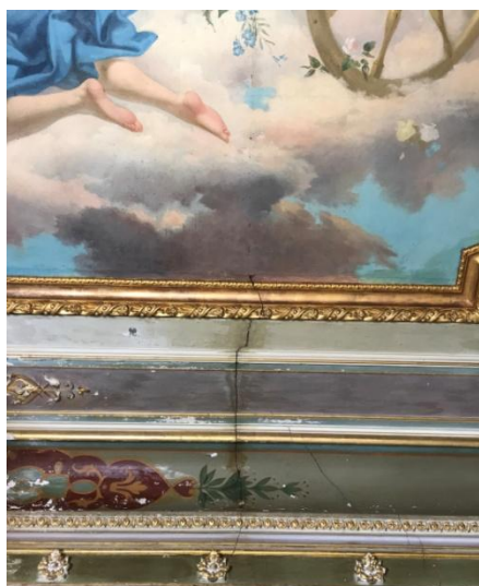
Figura 29. Grieta estructural que se prolonga longitudinalmente hasta la obra.
