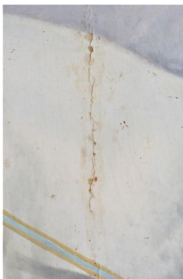
Figura 31. Exudación de adhesivo de naturaleza desconocida sobre la obra.
