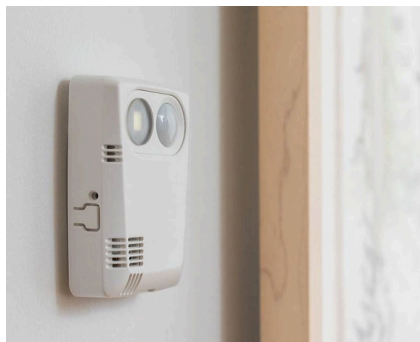
Figura 34: Sistema de supervisión de temperatura, humedad relativa, iluminación, CO 2 y aire comprimido.
