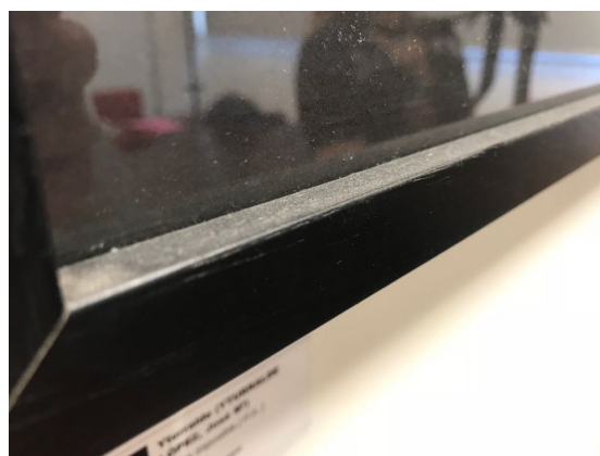
Figura 5: Acumulación de polvo en el marco.
