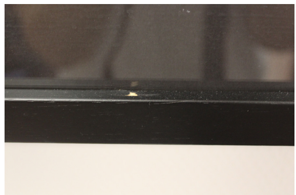
Figura 5: Golpe en la parte inferior del marco, con pérdida de pintura.
