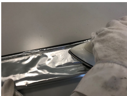
Figura 37: Adesión del aislante Marvelseal mediante una plancha de calor sobre el marco de madera.
