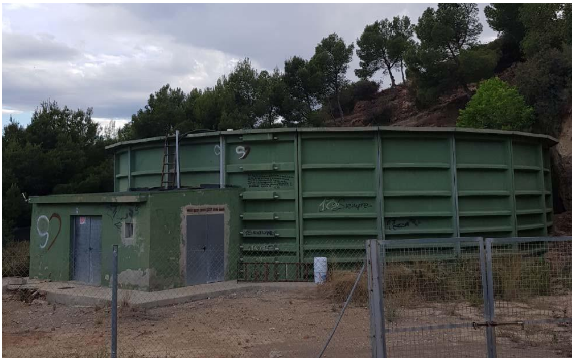
Figura 15. Fotografía del depósito Intermedio.
