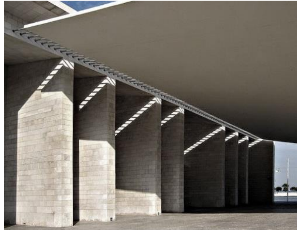
Imagen 3.2 Encuentro de la cubierta y el muro
