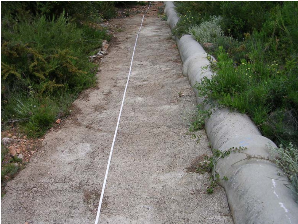
FOTOGRAFÍA Nº39: “Fuerzas pendientes. Existencia de algunos tramos hormigonados”.
