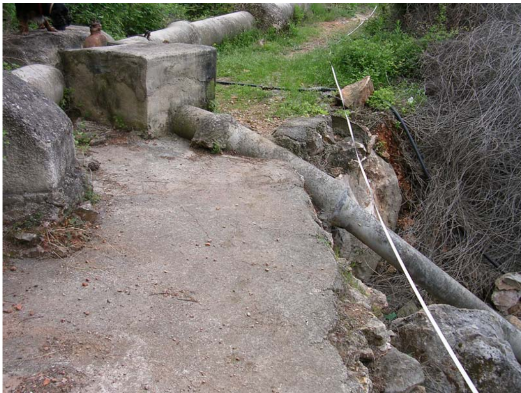
FOTOGRAFÍA N°35: “Elementos del Canal Alt que dificultan el paso”.
