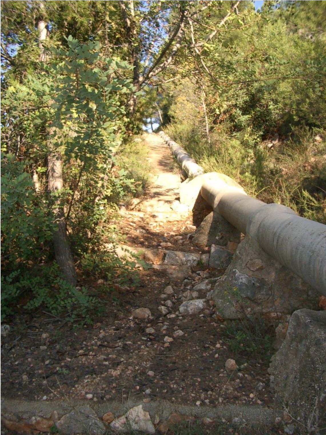
FOTOGRAFÍA Nº40: “Suelo muy pedregoso. Existencia de escalera en mal estado”.
