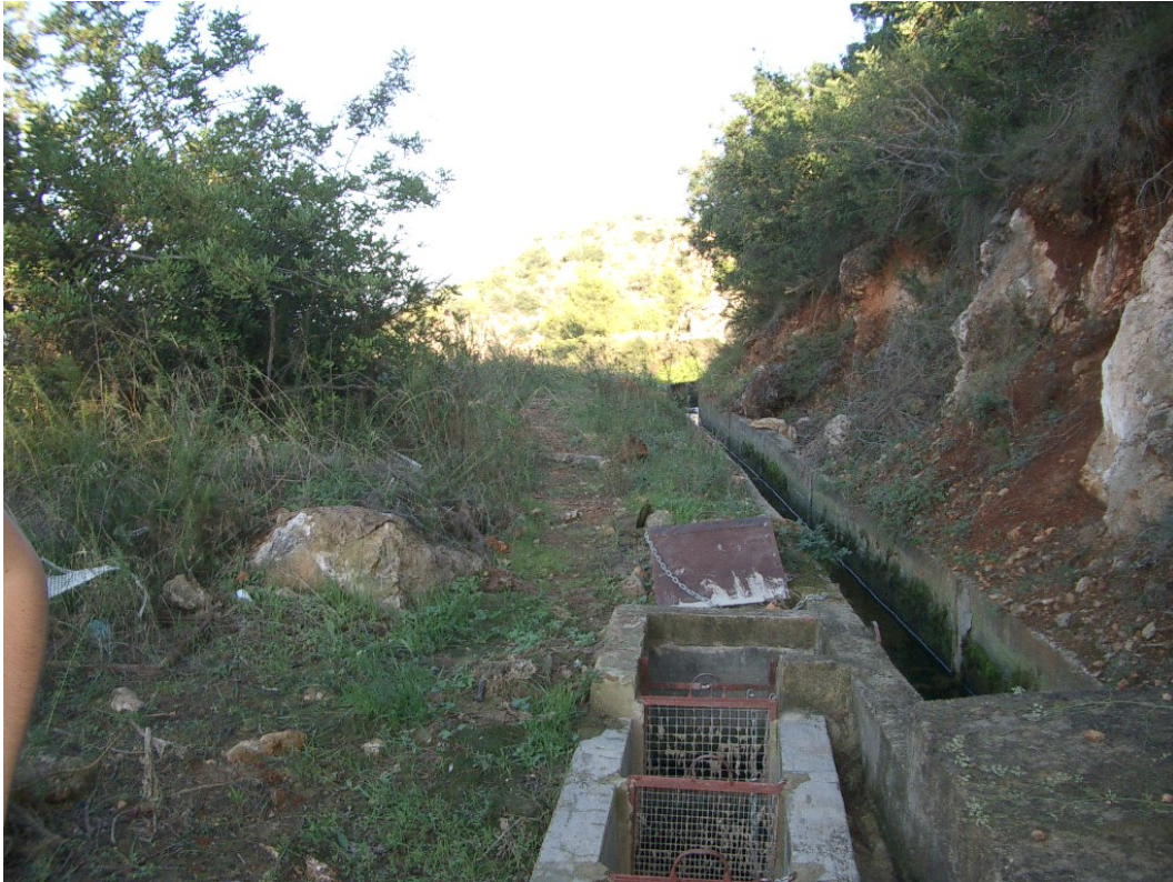
FOTOGRAFÍA Nº41: “Elementos del Canal Alt que dificultan el paso”.
