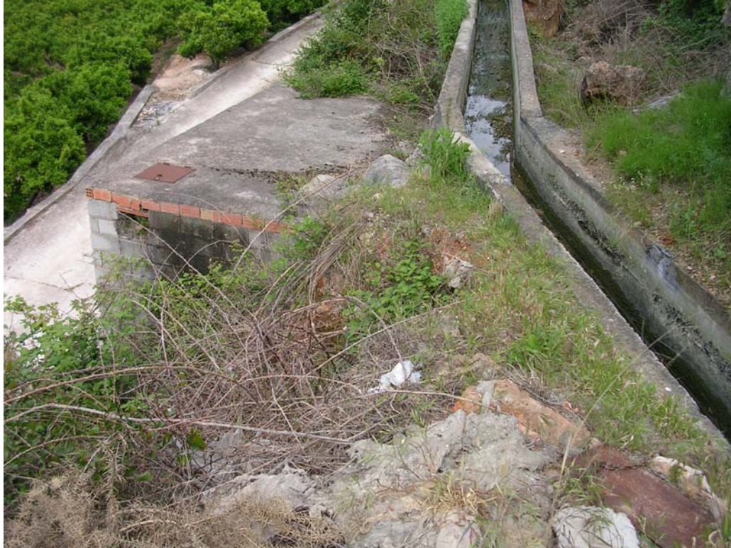
FOTOGRAFÍA Nº42: “Zonas de paso peligrosas”.
