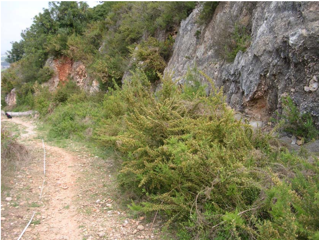
FOTOGRAFÍA N°14: “Existencia de matorral degradado que invade la vía”.
