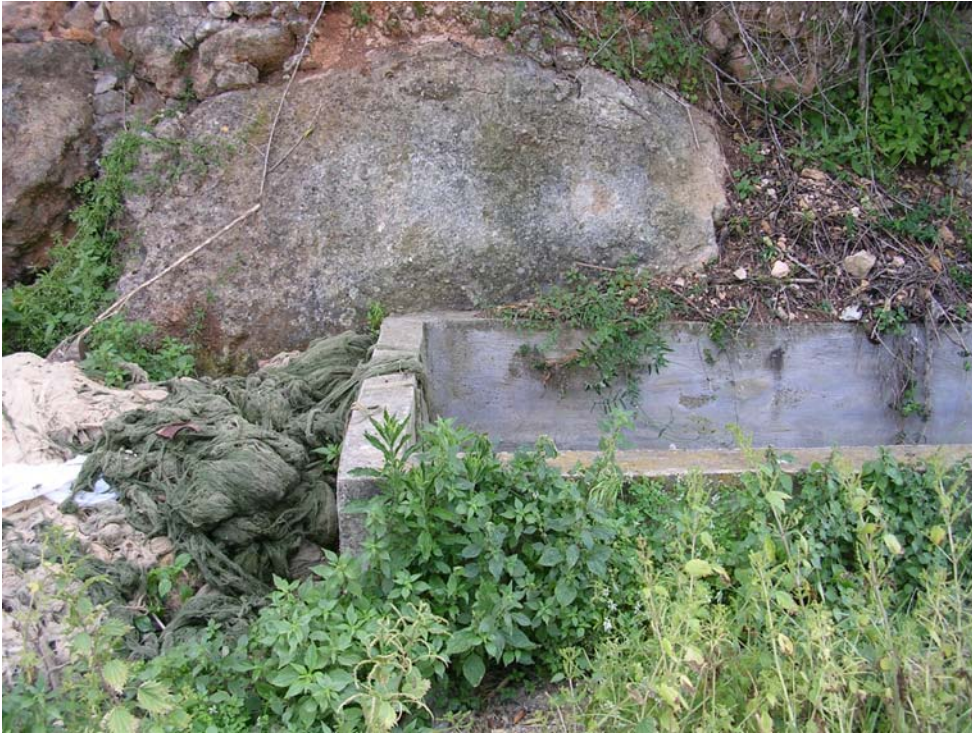
FOTOGRAFÍA Nº32: “Aparición del Canal Alt en forma de acequia. Existencia de restos de vegetación a eliminar”.
