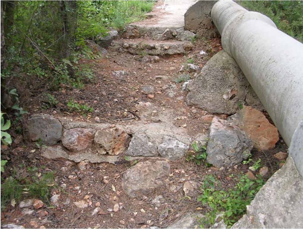
FOTOGRAFÍA Nº38: “Escaleras en mal estado para salvar las pendientes existentes”.
