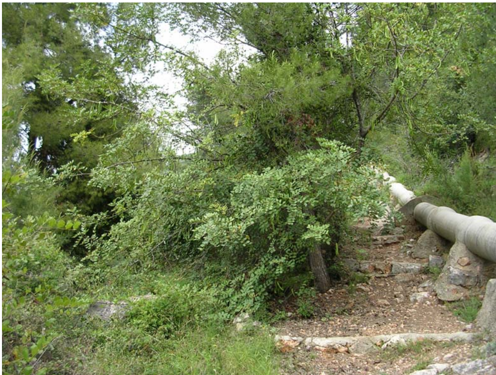
FOTOGRAFÍA Nº37: “Vegetación arbórea que invade la zona de paso”.
