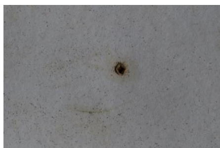
Imagen 29. Orificio oxidado causado por la punta de un compás
