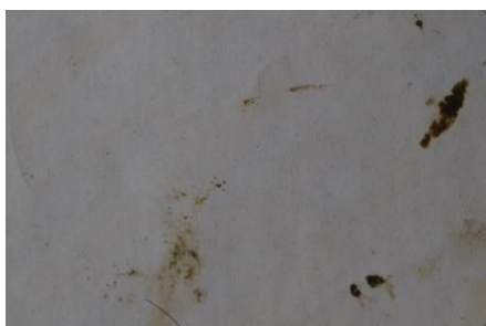
Imágenes 31 y 31. Manchas de adhesivo oxidado con relieve
