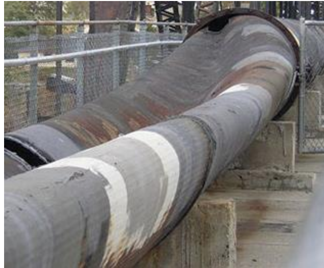
Figura 24. Ejemplo de colapso de una tubería
