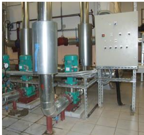
Figura 27. Cuadro estación de bombeo
