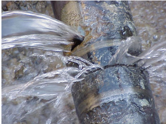
Figura 26. Ejemplo rotura de tubería
