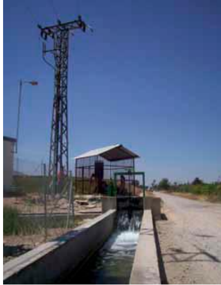
Figura 3. Bombeo alimentado por energía eléctrica en la CR de Albaterra, Alicante
