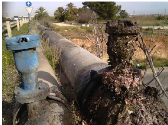
Figura 36. Mal mantenimiento de una ventosa
