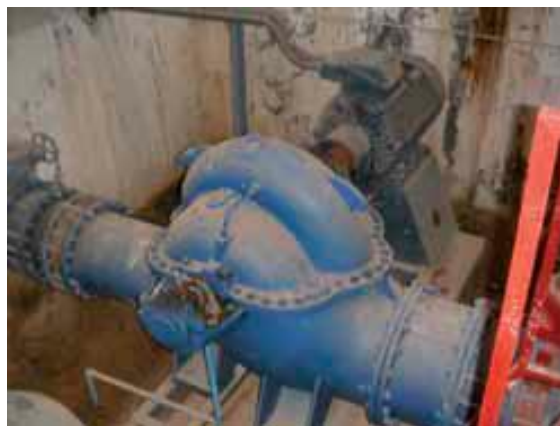
Figura 5. Grupo de bombeo con mal mantenimiento
