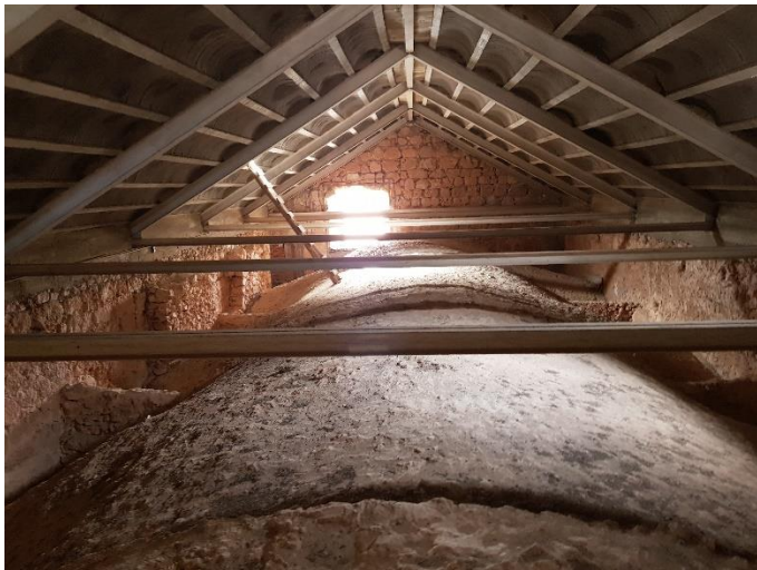
Figura 18. Estado de cubierta en el interior, 2018.
