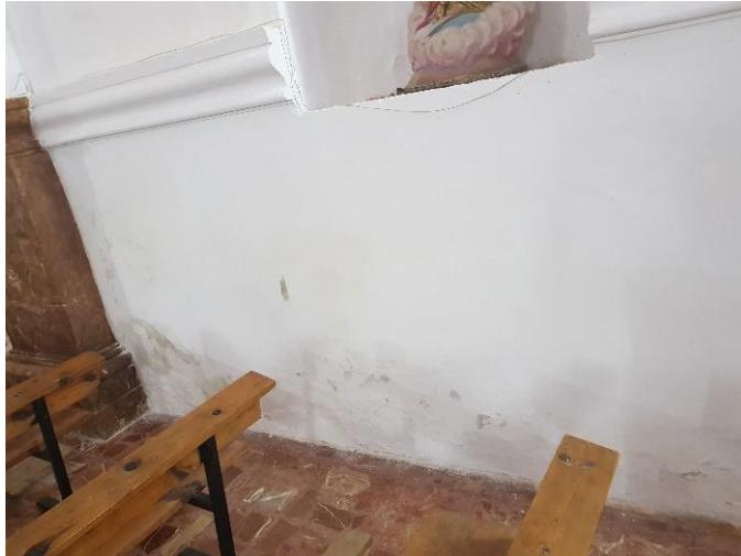
Figura 21. Presencia de humedad por capilaridad de la iglesia, 2018.
