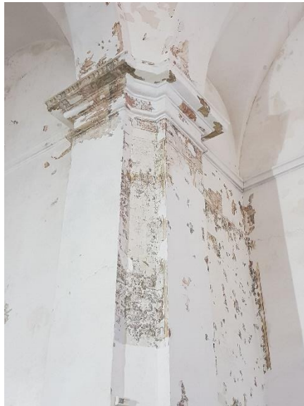
Figura 20. Estado de una columna de la iglesia, 2018.
