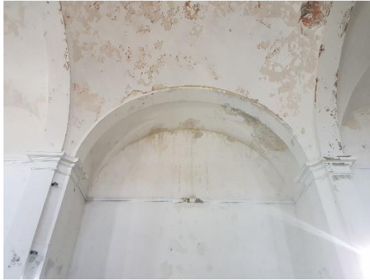
Figura 19. Estado del interior de la iglesia, 2018.
