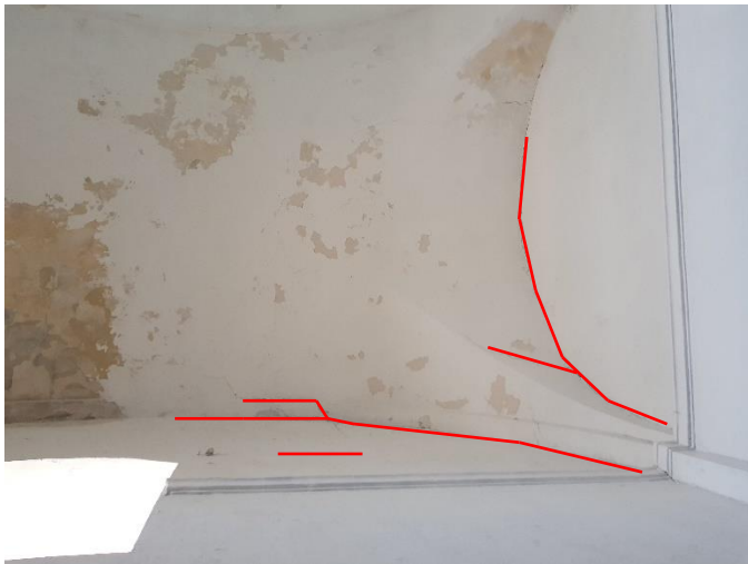
Figura 16. Presencia de fisuras en el interior de la iglesia, 2018.
