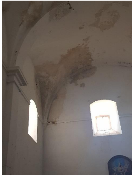
Figura 22. Presencia de humedad por filtraciones de la iglesia, 2018.
