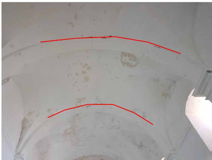
Figura 17. Presencia de fisuras en los arcos de la iglesia, 2018.
