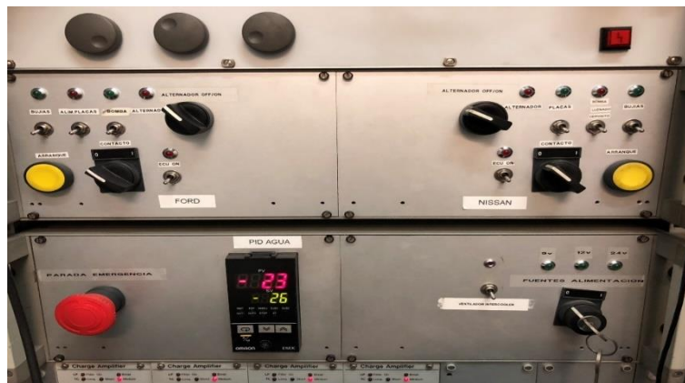
Figura 21. Rack de control
