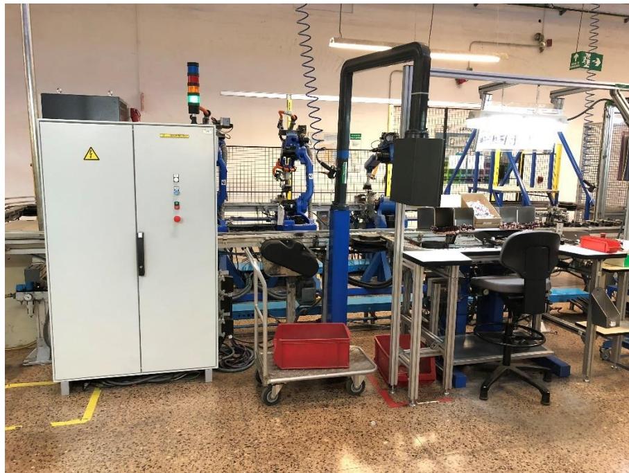
Figura 2: Puesto Manual y cuadro eléctrico de la línea.
