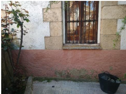
Figura 63. Hongos y moho en la parte inferior del zócalo. 2018. Fuente: Propia.
