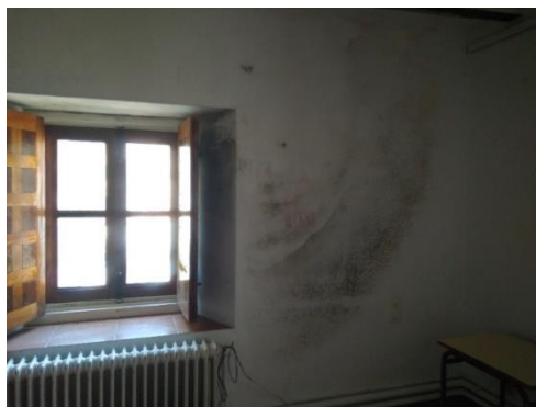
Figura 66. Mancha de humedad en paramento vertical. 2018. Fuente: Propia.
