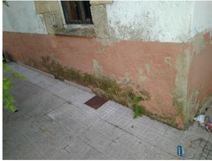
Figura 64. Hongos y moho bajo ventana. 2018. Fuente: Propia
