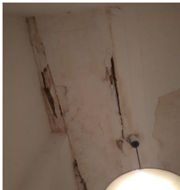
Figura 65. Patología del forjado. 2018. Fuente: Propia.
