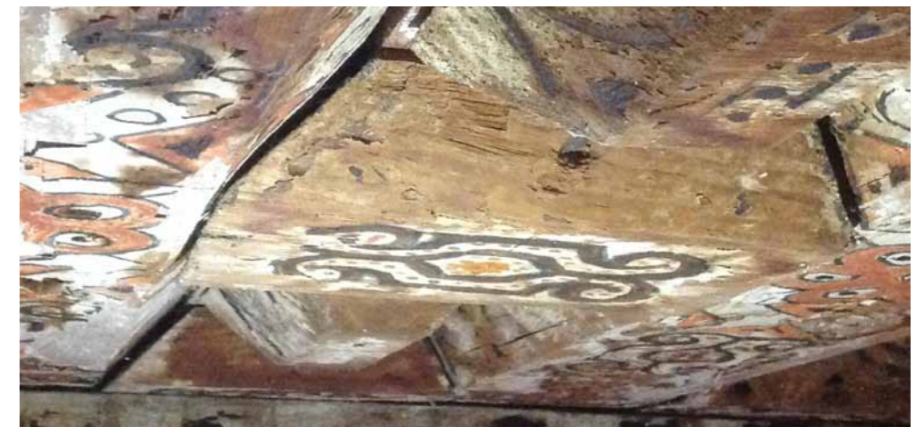
Figura 6:99. Vista rasante de la techumbre. Las separaciones que se observan entre los cuarterones y las vigas son en su mayoría por la talla original de la estructura. Los cuarterones y las vigas presentan buena solidez y estado de conservación. (Foto: K. Muñoz Alcocer, 2015).
