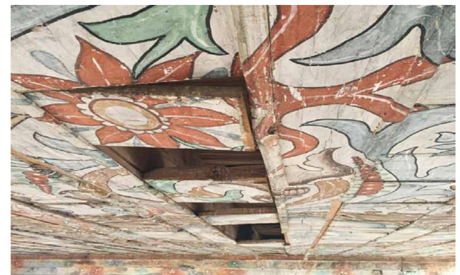
Figura 6:93. Vista rasante del entablado, se observa la disposición irregular y pérdida de las tabletas a causa del desprendimiento de los listones. (Foto: K. Muñoz Alcocer, 2016).
