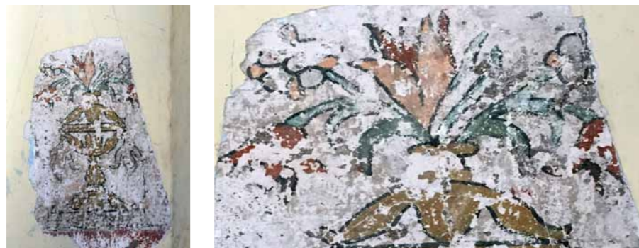
Figura 6:59. Vista general y detalle de los floreros descubiertos debajo de capas de cal y pintura vinílica en el área del sotocoro. (Fotos: K. Muñoz Alcocer, 2005).
