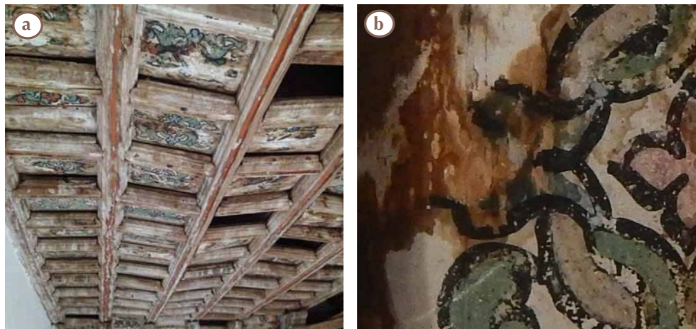
Figura 6:98. Vista rasante del alfarje que permite observar la deformación de la estructura a causa del movimiento de los peinazos a); Detalle de la policromía mostrando manchas de humedad y pérdida de policromía. (Fotos: K. Muñoz Alcocer, 2015).
