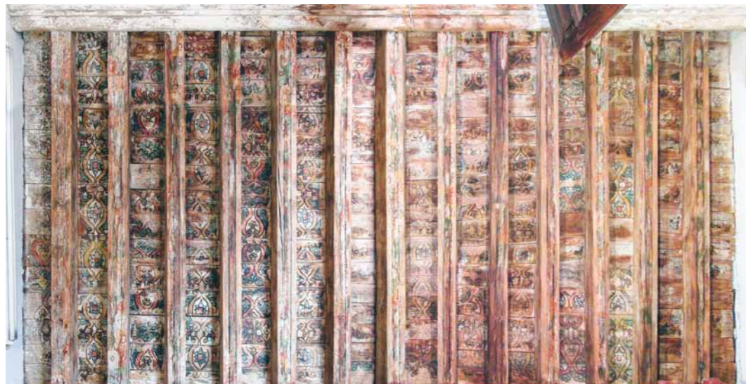
Figura 6:49. Vista general de la techumbre del sotocoro formada por un forjado de vigas y tabletas a la vista. (Foto: Isaac Rangel Chávez, Instituto de Física UNAM, 2016).
