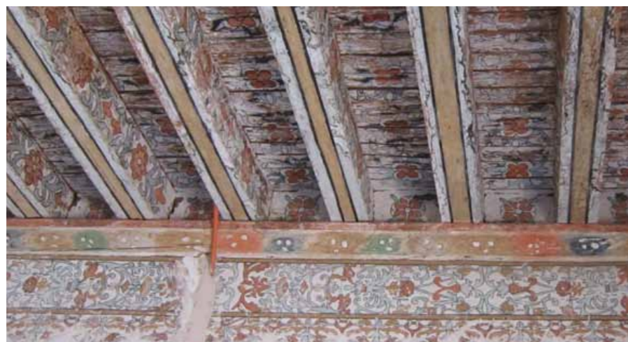
Figura 6:92. Vista del forjado y pintura mural de la sacristía donde se observa el paso de tubos de la instalación eléctrica, dañando la pintura original. (Foto: K. Muñoz Alcocer, 2016).
