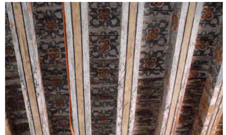
Figura 6:69. Detalle de la techumbre de vigería del baptisterio. Muestra la decoración de las latillas y vigas. Nótese que los elementos decorativos en las latillas están distribuidos a distancias variadas entre uno y otro. (Foto: K. Muñoz Alcocer. 2016).
