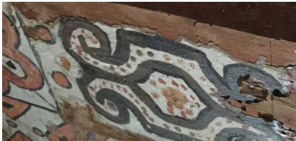
Figura 6:100. Filtraciones de humedad han ocasionado la pérdida de policromía. Detalle de la figura con volutas de un cuarterón, donde se aprecia la mala adherencia de la base de preparación a la madera. (Foto: K. Muñoz Alcocer, 2015).
