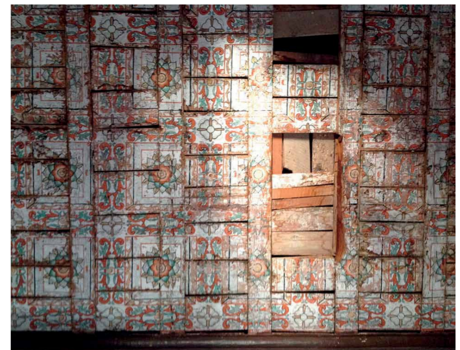
Figura 6:94. Vista del techo del sotocoro donde se observan la pérdida de tabletas originales y sustituidas por trozos de madera. (Foto: K. Muñoz Alcocer, 2017).
