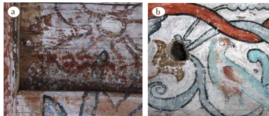
Figura 6:95. Detalle de la techumbre de la nave que muestra el exudado de resina. Se observan salpicaduras de pintura vinílica azul (a); detalle de la pintura mural que muestra la degradación del color verde en azul a causa de exposición de luz (b) (Fotos: K. Muñoz Alcocer, 2016).
