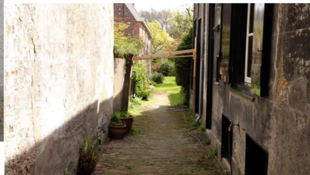
11. El pasaje en 2017 (el muro se está derrumbando)
