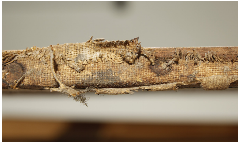
Fig. 8. Detalle de la degradación causada por el óxido férrico de los clavos de sujeción
