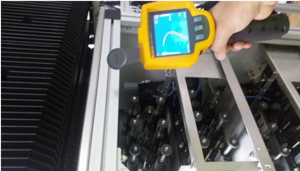
Cable con elevada temperatura
