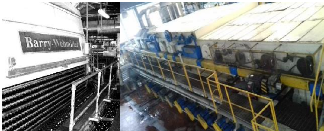
FIGURA 3.2 Vista frontal del cargador de botellas y vista lateral de la lavadora industrial.
