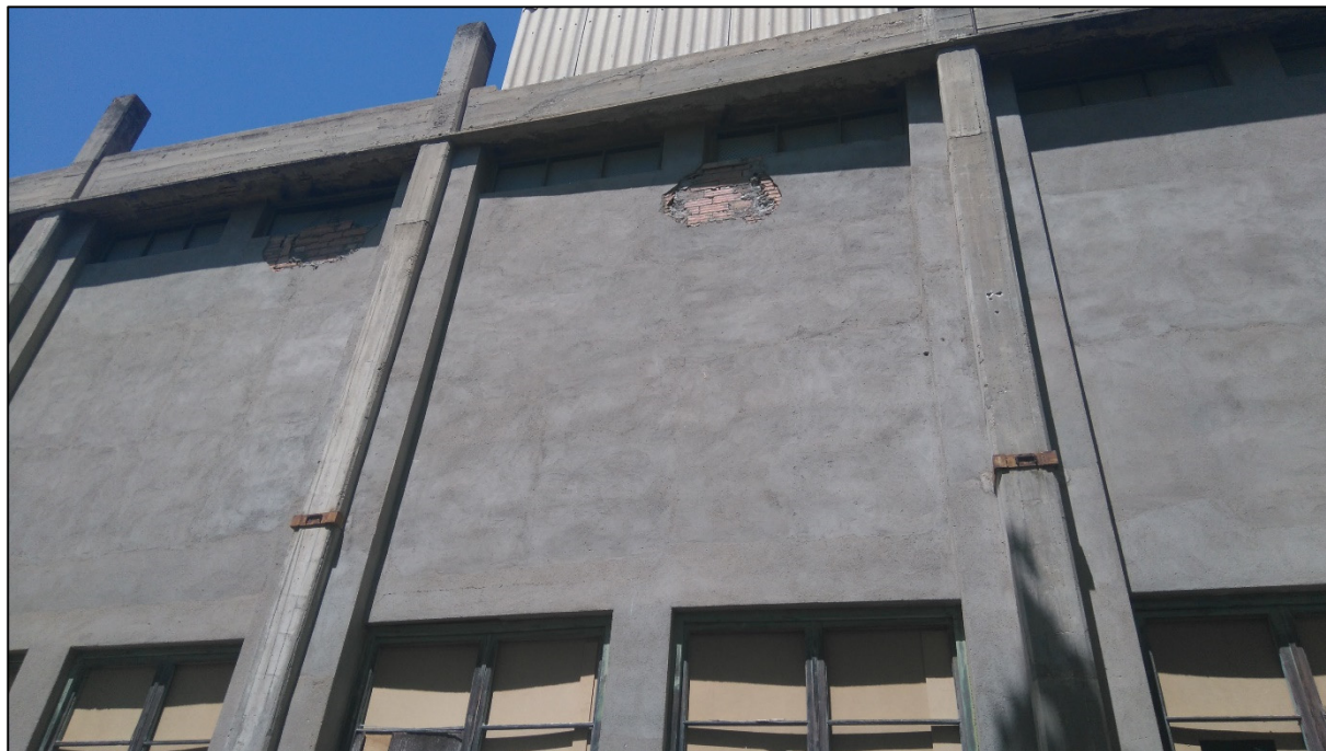
Ilustración 13 - Desconchón en la fachada de la grada.
