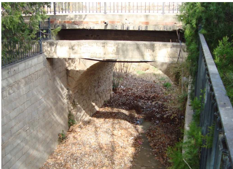
Il·lustració 31 - Imatge del pont de maçoneria des d'aigües amunt (FONT: elaboració pròpia)
