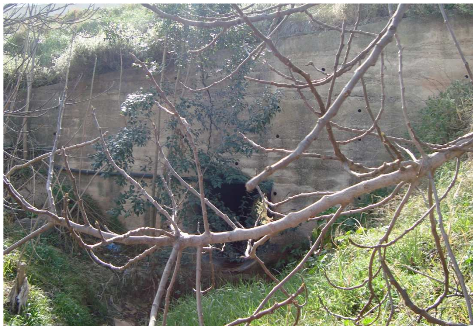
Il·lustració 33 - Imatge del detall de la fractura dalt del tub en el mur de formigó del costat nord de la nacional (FONT: elaboració pròpia)
