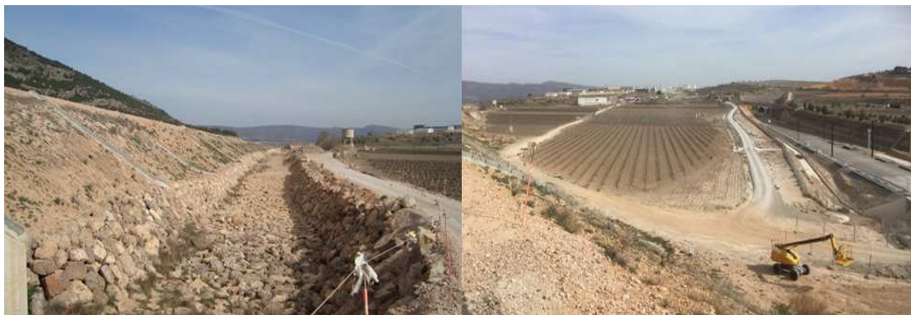
Il·lustració 5 - Imatge del canal construït paral·lel a l'autovia A-33 (FONT: elaboració pròpia) i imatge de l'endorreïme de la Foia de Manuel (FONT: Juan B. Marco Segura)
