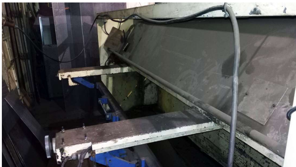
Detalle 1. Imagen del conjunto mecánico del tope trasero - Se puede observar que no está el motor en su ubicación ya que se desinstaló por avería.
