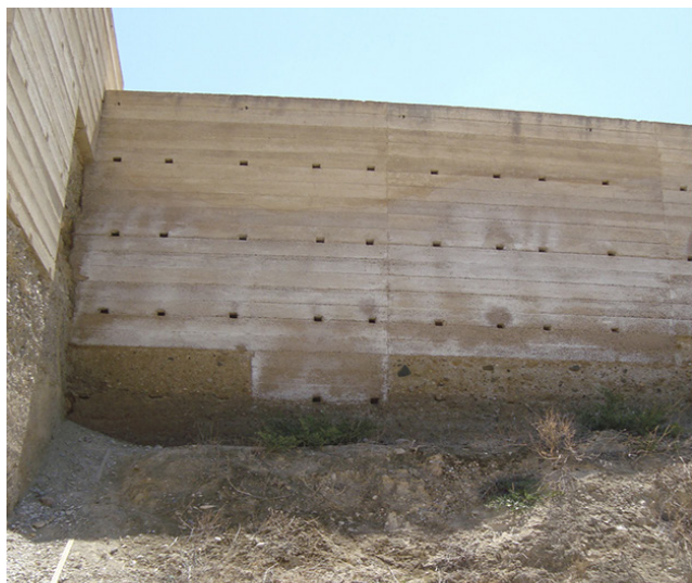
A. Estado actual del Castillo de Nugalte en la que se aprecian las manchas y eflorescencias de sales producidas por el agua que asciende por capilaridad.
