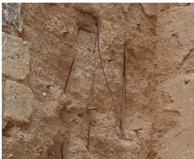
C. Estado actual de la Muralla de Niebla, en la que se aprecia que se han producido desprendimientos superficiales
