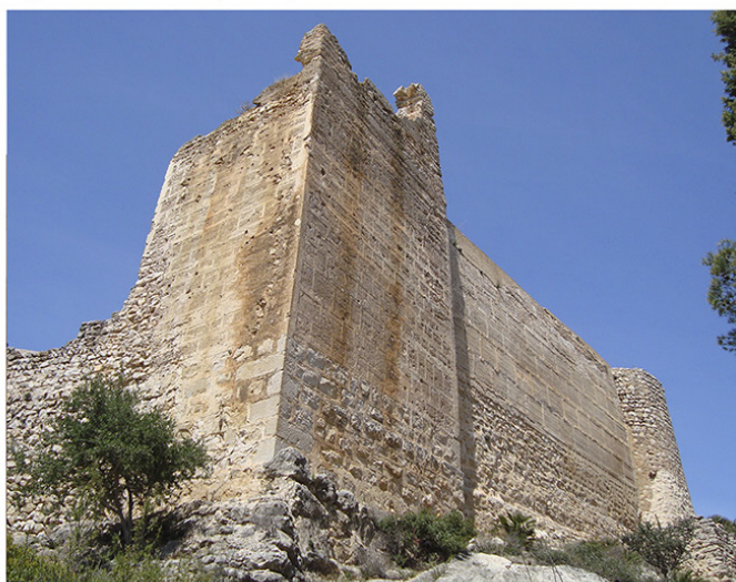
D. Estado actual Imagen actual del Castillo de Alcalá de Xivert en la que se aprecian las manchas de suciedad producidas por las escorrentías superficiales de agua desde la coronación.
