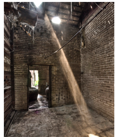
FIGURA 118. Estado previo a la intervención
