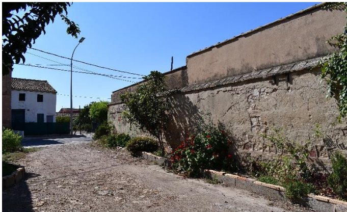
Figura 85 – Vista del muro del antiguo Matadero de En Corts en su porción lateral. Se nota que en la parte inferior el enlucido se está soltando de la pared, dejando a la vista el sistema constructivo. (Fuente: acervo personal de Gracia López Patiño, 2018)
