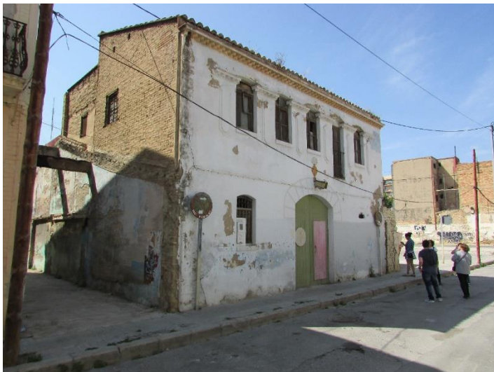
Figura 108 – Vista de la edificación del antiguo Matadero del Cabañal, en época de su fundación llamado Matadero de Pueblo Nuevo del Grao. Es evidente el estado de abandono en que está el edificio. (Fuente: acervo personal de la autora, 2018)
