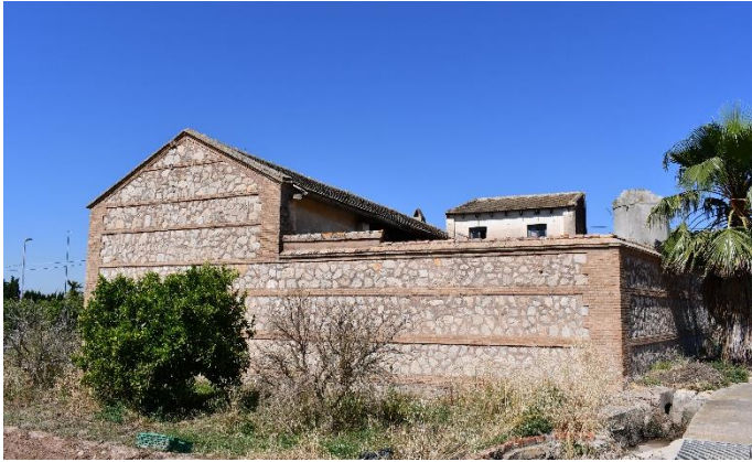
Figura 69 – Vista de la fachada posterior del conjunto del Matadero de Borbotó, donde se puede observar el volumen con cubierta a dos aguas correspondiente a la nave de matanza. Aún se nota un pequeño trozo remanente del cobertizo que se desarrollaba al lado de esta, siguiendo todo el largo del muro posterior. (Fuente: acervo personal de Gracia López Patiño, 2018)
