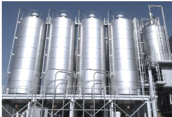
Ilustración 33. Silos de acero inoxidable.
