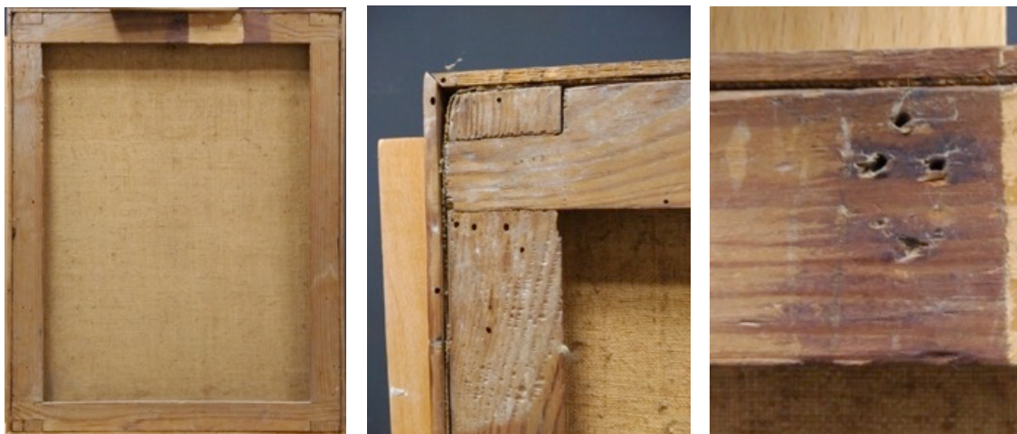
Fig. 33 Vista general de bastidor, Fig. 34. Detalle de la unión entre listones y orificios de insectos xilófagos, Fig.35.Detalle de agujeros del anclaje.
