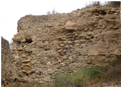
FIG. 9. Tapia de calicanto donde se observan partes con costra y partes donde la costra se ha desprendido por efecto de la erosión y se ve el mampuesto interior, en L8.
