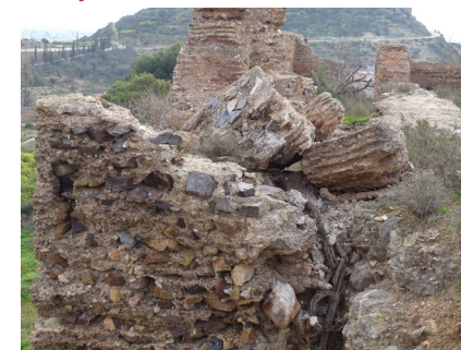
FIG. 32. Desprendimientos de partes de las fábricas en el interior de la torre 7.
