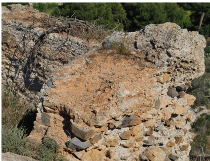
FIG. 16. Disgregaciones en la superficie de coronación, torre 10.
