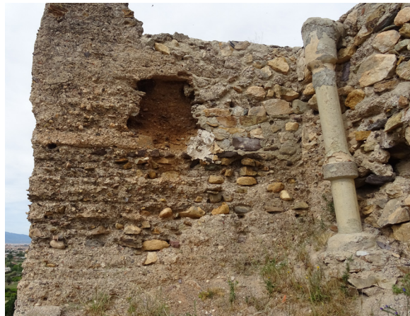
FIG. 72. Lienzo 7. La construcción de la balsa, además de la destrucción del patio, tuvo otras consecuencias como aperturas de huecos en muros o colocación de tuberías y otras instalaciones para el riego de la finca agrícola, como esta tubería de fibrocemento.
