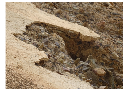
FIG. 28. Desconchados y desprendimientos de revestimientos originales.
