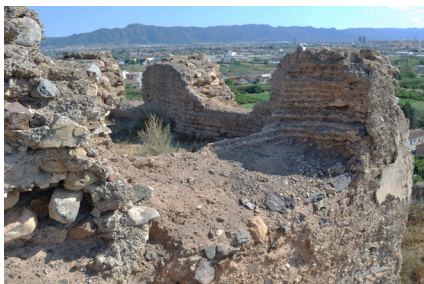
FIG. 17. Coronación de la torre 16 con disgregaciones de aspecto terroso.
