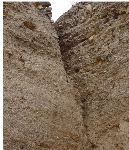
FIG. 20. Discontinuidad observada entre T8 y L6. Se detectan mechinales en el encuentro entre las fábricas.
