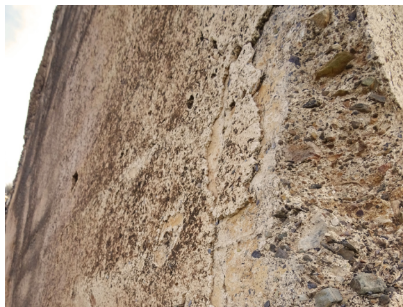
FIG. 57. Torre 4. La capa de revestimiento en su esquina comienza a desprenderse, exponiendo la costra de la tapia en perfectas condiciones de conservación.
