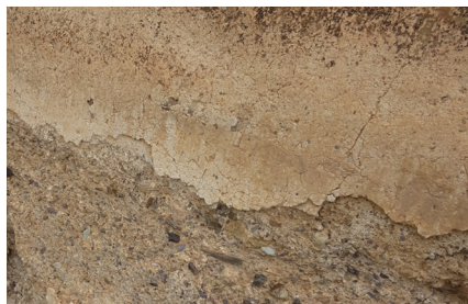
FIG. 23. Fisuración de los revestimientos en la torre 16.
