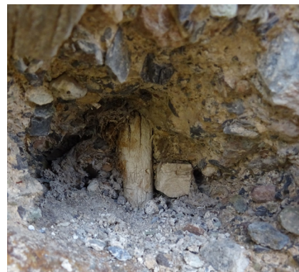
FIG. 15. Detalle del único clavo encontrado en el interior de la fábrica de la T3. A su derecha se detecta madera de la aguja.
