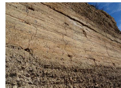
FIG. 27. Erosión diferencial del muro. Costra de la tapia original en la parte central.
