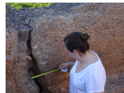
FIG. 33. Medición y revisión de grietas en los interiores de la torre 4.
