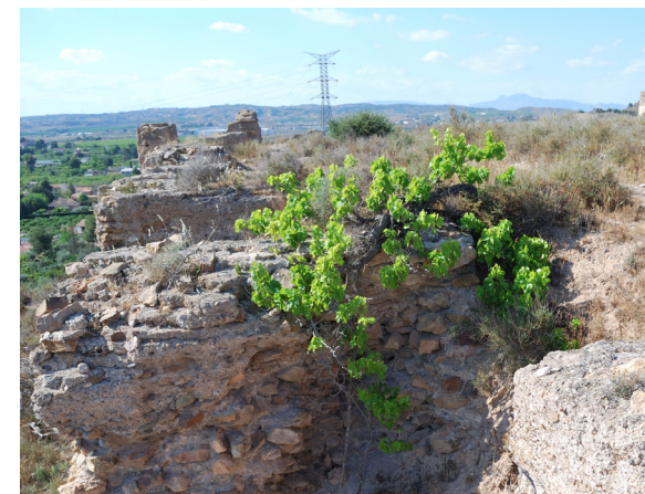
FIG. 44 Torre 14. Una parrá crece y trepa por los muros de la torre. Esta vegetación leñosa puede producir roturas internas en el muro que terminen ocasionando su disgregación.
