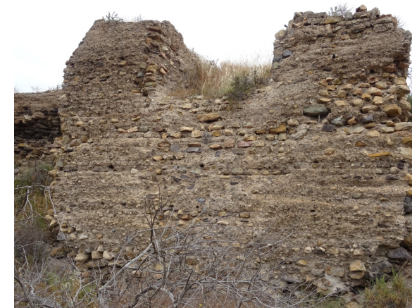
FIG. 35. Torre 14. La erosión del muro en superficie marca las tongadas de la tapia de calicanto y los mampuestos internos que la componen.
