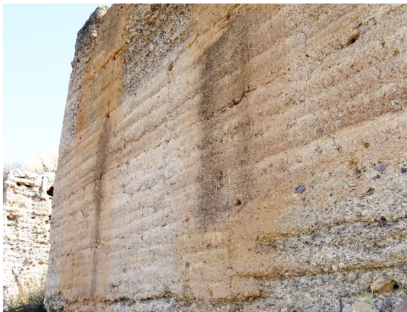
FIG. 38. Torre 24. Apenas se observa degradación de la costra de la tapia en esta torre. Posee un estado de conservación muy bueno y se llegan a apreciar las tablas de madera del encofrado grabadas sobre la costra. En la esquina inferior derecha y la parte superior se detecta la disgregación del material.
