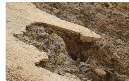
FIG. 26. Pérdida de adherencia del revestimiento con el soporte en la torre 1.
