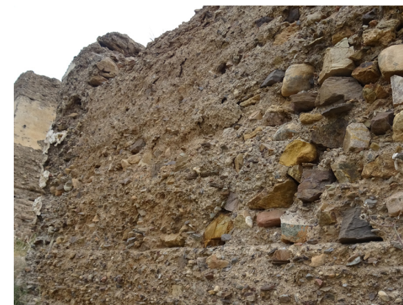
FIG. 36. Torre 2. Gracias a la erosión se detectan las tongadas y niveles de la tapia. En algunas partes, la erosión ha sido mayor exteriorizando el mampuesto de la tapia de calica.
