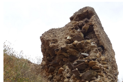
FIG. 18. Coronación con erosión profunda y con peligro de desprendimiento en la torre 6.
