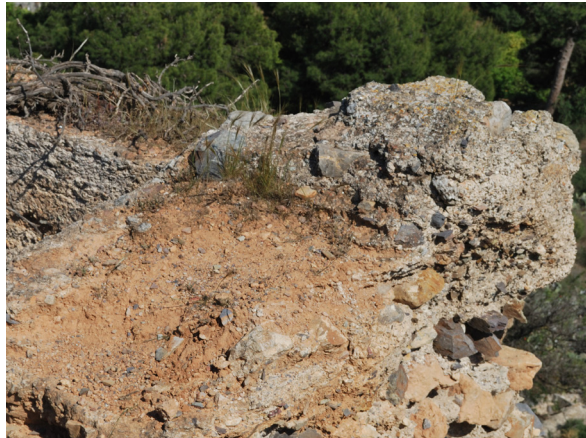
FIG. 45. Torre 9. Vegetación de baja ramificación florece sobre los restos del muro de tapia. Su florecimiento y crecimiento puede conducir a generar lesiones de importancia.
