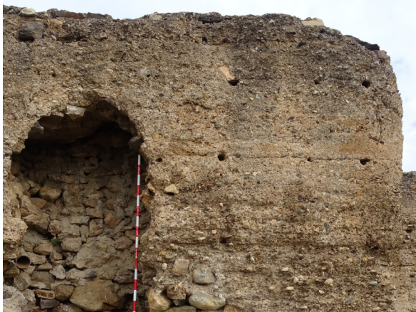
FIG. 53. Torre 12. El depósito de polvo y de las partículas contaminantes producen el ennegrecido de la coronación y partes altas del muro.
