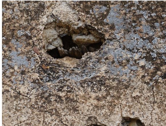
FIG. 47. Torre 1. Revestimiento exterior en su cara Oeste. Sobre el revestimiento se aprecia la proliferación de hongos y especies vegetales microscópicas que pueden producir alteraciones y disgregaciones de material importantes.
