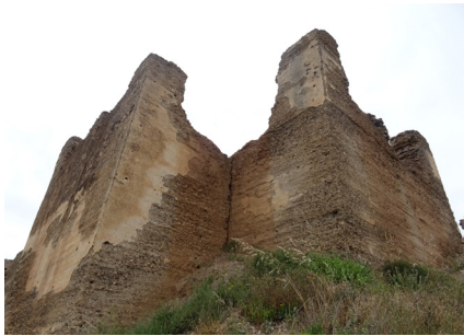
FIG. 17. La discontinuidad de las fábricas aparece en forma de grieta en las esquinas entrantes. Encuentro entre T3 y T4.
