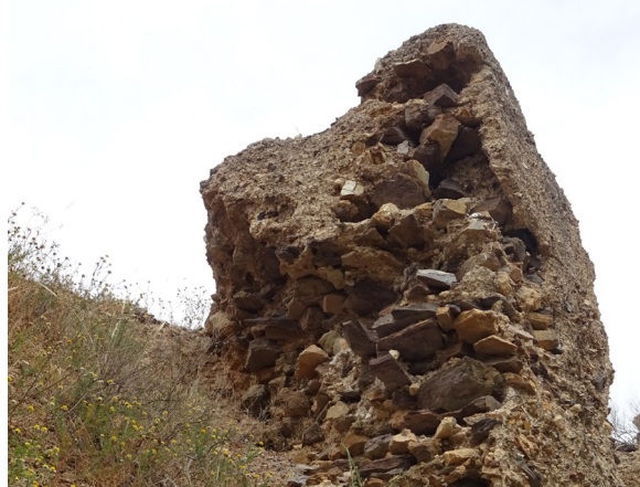
FIG. 32. Torre 6. Inestabilidad en la coronación de la torre producida por la erosión. La pérdida de material en partes inferiores a causa de la erosión compromete la estabilidad de las partes superiores y del muro.
