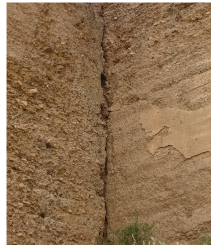
FIG. 21. Detalle de la grieta formada en la esquina entrante entre T3 y T4.
