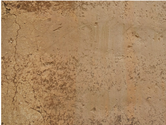
FIG. 61. Torre 16. La exposición a condiciones climáticas, en ocasiones extremas, produce contracciones y dilataciones del revestimiento, y su consecuente fisuración. La fisuración es el primer indicio de esta patología.
