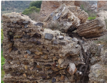
FIG. 15. Derrumbes en las coronación del muro de la torre 7.
