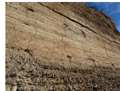
FIG. 73. Degradación de la costra superficial en la fábrica de la torre 13.
