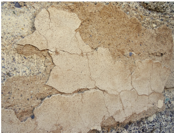
FIG. 62. Torre 3. Cara interior de la torre. Se aprecia una doble capa de acabado. Sobre la última capa se produce el cuarteado, y en algunas partes, se detecta el desprendimiento de esta última capa.
