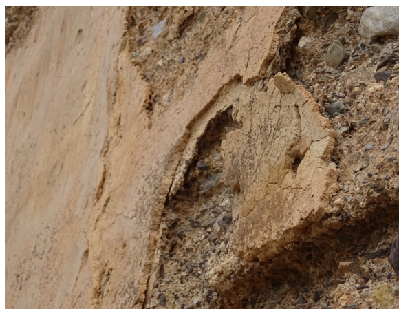
FIG. 58. Torre 16. El desconchado de los revestimientos permite la entrada del viento y el agua entre sus hendiduras, provocando la desunión de los materiales y su desprendimiento.
