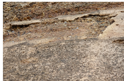
FIG. 24. Desconchado y pérdida de material en los revestimientos de la torre 1.
