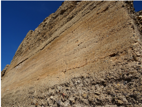
FIG. 37. Torre 13. Desprendimiento de la costra en las partes superiores e inferiores de la torre. En la parte central se observa el buen estado de conservación de la costra.
