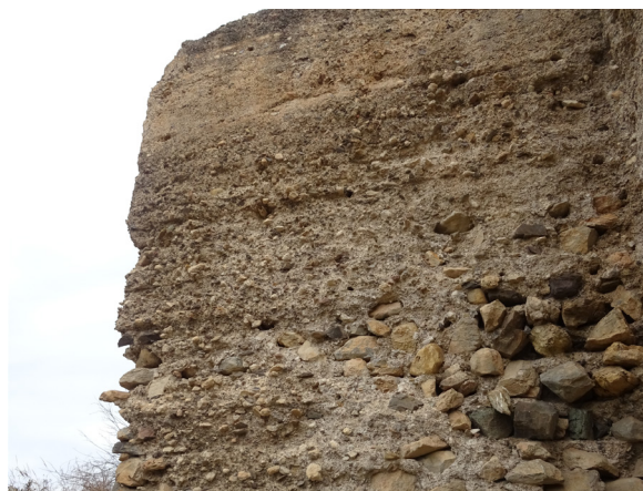
FIG. 34. Torre 12. En su cara Sur se observa como la erosión marca las líneas de ejecución de la tapia. Se distinguen en algunas partes, los mampuestos del núcleo de la fábrica.
