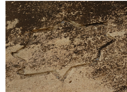
FIG. 21. Importante presencia de costra negra y suciedad sobre los esgrafiados de la torre 4.
