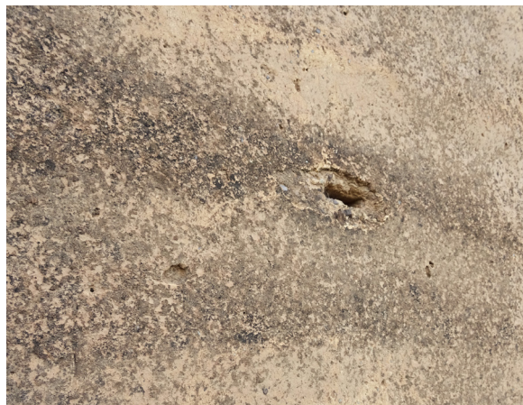
FIG. 56. Torre 1. Ennegrecimiento del revestimiento causado por contaminantes y biodeterioros superficiales. Su alteración química, por efecto de otros agentes atmosféricos, puede producir roturas y disgregaciones del revestimiento.
