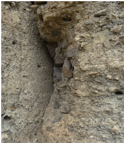
FIG. 24. Detalle del encuentro T8 y T9. Se observan la diferente situación de los mechinales de la T8, la T9 y la fábrica interna.
