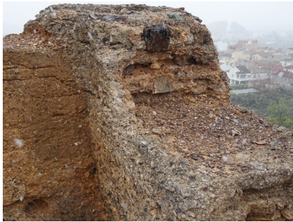
FIG. 1. Coronación de la T8 donde se detecta la costra interior y la presencia de tierra.
