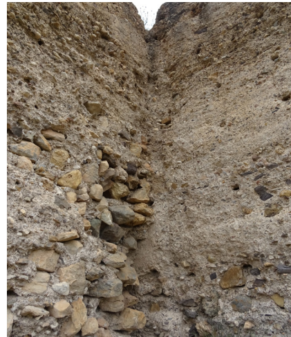
FIG. 25. Se detecta la discontinuidad entre las torres y la fábrica interior, en la esquina entrante entre T11 y T12.
