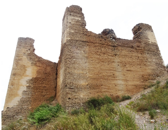
FIG. 50. Torre 4 y 5. La falta de protección de una cubierta o vierteaguas se traduce en escorrentías que discurren de manera desigual aportando alteraciones cromáticas sobre la superficie de los muros.
