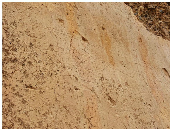
FIG. 65. Torre 16. Los grafitis o grabados sobre los revestimientos históricos alteran estéticamente los revestimientos y pueden llegar a deteriorarse a causa de la erosión o la alteración química que puedan producir.
