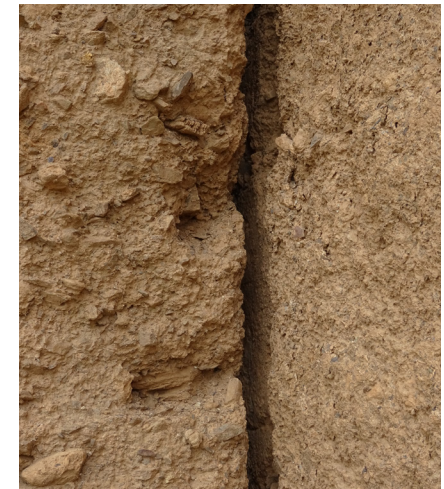
FIG. 22. Detalle de la discontinuidad entre T3 y T4. Se aprecia una textura diferente en la cara interna del encuentro.
