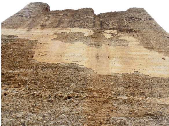
FIG. 54. Torre 4. Sobre el revestimiento se observa la denominada costra negra, producto de la transformación química de líquenes y partículas contaminantes por la acción del sol y la lluvia.
