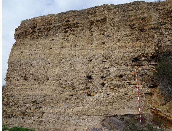
FIG. 55. Torre 11. El agua de lluvia junto con partículas procedentes de la contaminación atmosférica inician un proceso químico deteriorando y tiñendo las partes más elevadas del muro.
