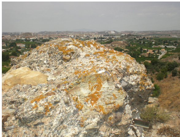
FIG. 46. Torre 1. Encuentro entre la torre 16 y la torre 1. Especies de líquenes se reproducen sobre su superficie, pudiendo originar pequeñas roturas y disgregaciones del mortero de cal que compone la tapia.
