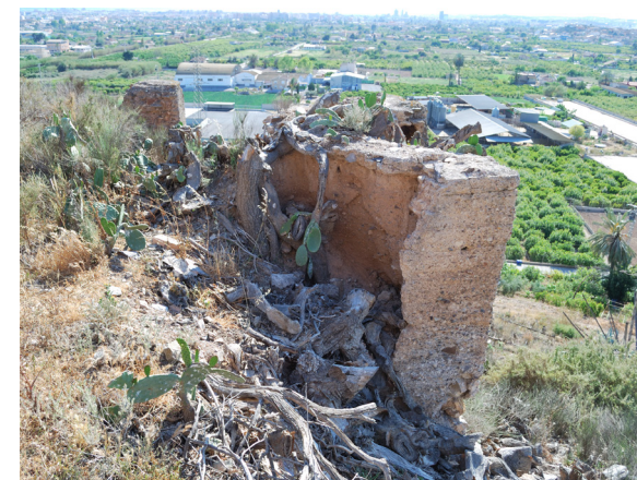
FIG. 43. Torre 18. La maleza y la vegetación, con especial atención a la chumbera, produce roturas en el interior del muro y se desploma sobre él. La sobrecarga y los empujes de la vegetación pueden producir su derrumbe.
