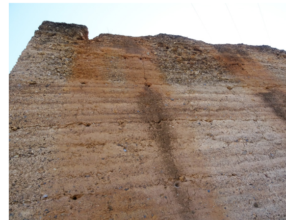
FIG. 52. Torre 24. El arrastre de partículas por el agua de lluvia produce el lavado, la erosión y el cambio de tonalidad en la fachada de la torre.
