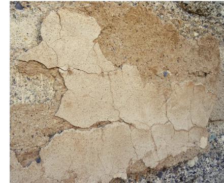
FIG. 22. Cuarteado de revestimientos en el interior de la torre 3.
