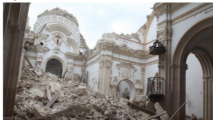
FIG. 12. Derrumbe del crucero y parte de la nave central de la iglesia de Santiago de Lorca durante el terremoto de 2011.
