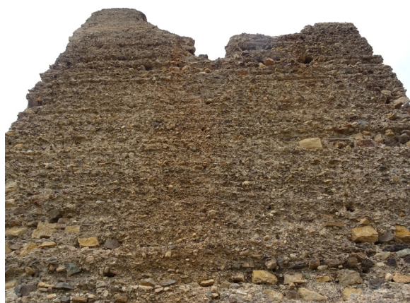
FIG. 33. Torre 7. Deterioro superficial del muro. Queda a la vista la mezcla de cal, grava y arena de la tapia, e incluso, el mampuesto en las partes inferiores.
