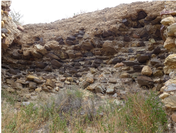
FIG. 29. Lienzo 11. Se ha desprendido la costra exterior y erosionado el muro, generando una importante pérdida de sección. El interior del muro queda visto y la parte superior de la fábrica de tapia volada.
