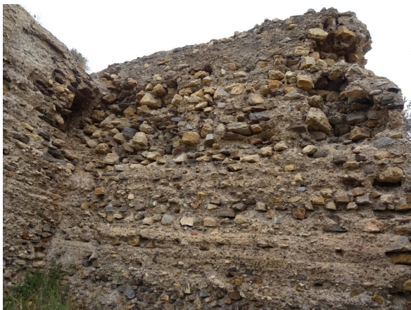
FIG. 30. Lienzo 9. Degradación importante y pérdida de sección causada por la erosión. El material débil de la mezcla se erosiona dejando a la vista el mampuesto interno, hasta que éste pierde su cohesión y termina cayendo.
