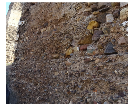
FIG. 16. Detalle de la zarpa, prácticamente erosionada, en la T2.
