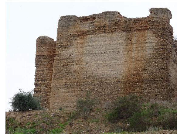
FIG. 51. Torre 8. El mal estado de las coronaciones y la disgregación de partículas son transportadas por el agua de lluvia a las caras del muro produciendo la decoloración que se muestra en la imagen.
