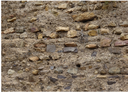
FIG. 8. Detalle de mampuestos organizados linealmente en hiladas en el muro de la T14.
