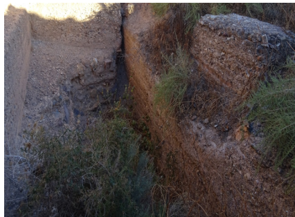
FIG. 25. Interiores de la torre 4. Al fondo se ve la grieta que la desconecta del muro interior.
