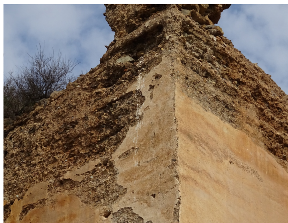
FIG. 66. Torre 11. Los excrementos de aves y otros animales originan procesos químicos degenerativos sobre los materiales. La fabricación de nidos o madrigueras también producen daños importante en los muros.
