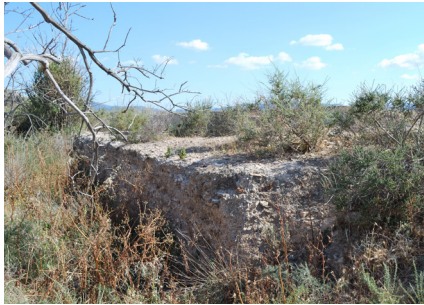
FIG. 6. La espesa vegetación no permite ver las estructuras murarias, produciendo paulatinamente su degradación.
