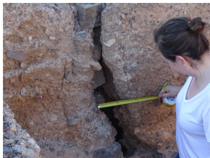
FIG. 26. Medición y comprobación de las grietas de la torre 4.
