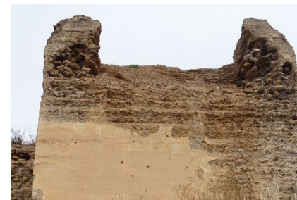
FIG. 19. Erosiones y disgregaciones en la coronación de la torre 10.
