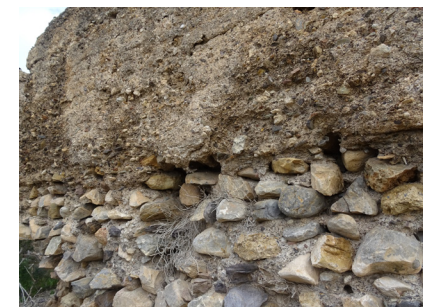
FIG. 26. Degradación del muro en su parte inferior por la erosión y la humedad.
