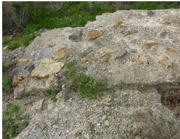
FIG. 48. Torre 6. En el encuentro de la torre 6 con el muro del recinto interior brota vegetación de tipo inferior. Su crecimiento puede causar pequeñas roturas superficiales y la entrada del agua en el muro.
