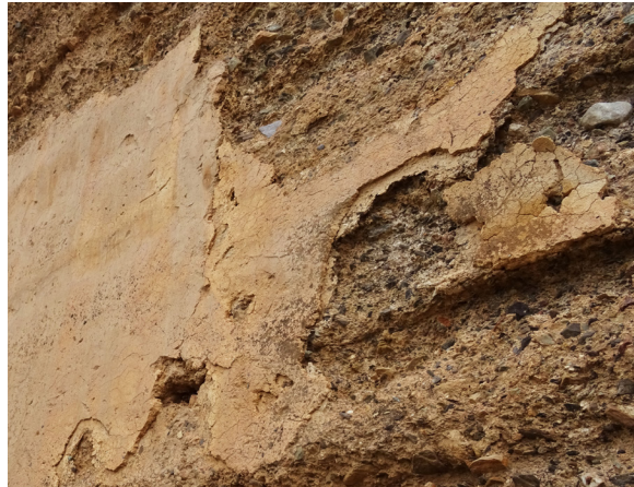
FIG. 64. Torre 16. La fisuración y el cuarteado genera la entrada de agua y tensiones intersticiales en el revestimiento que terminan por romper el material y provocar su pérdida.
