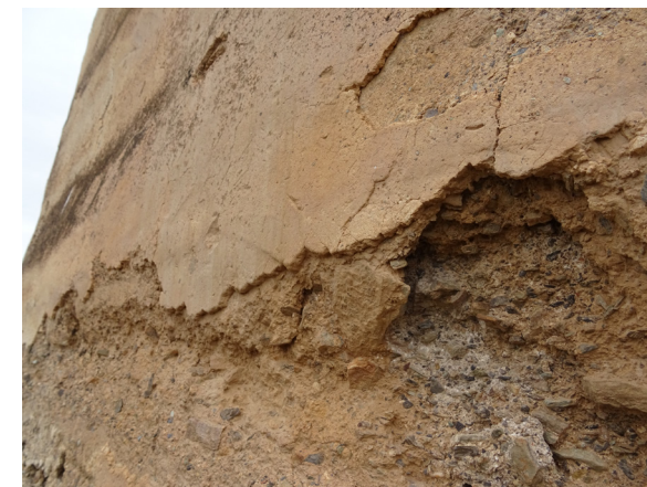
FIG. 59. Torre 16. Las malas condiciones y las irregularidades del soporte genera la fisuración y desconchado de revestimientos, dejando sin protección al muro.
