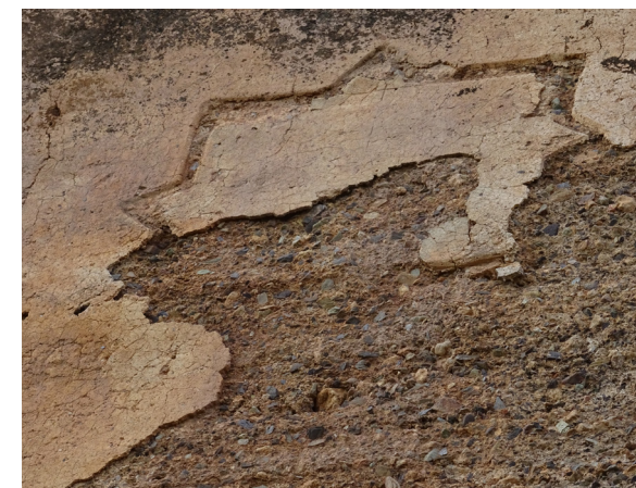
FIG. 60. Torre 4. La pérdida del revestimiento en la torre 4 se traduce en la destrucción de los esgrafiados históricos del Castillejo de Monteagudo.
