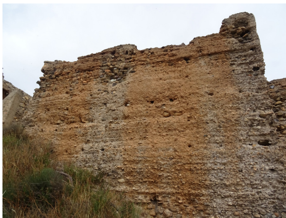
FIG. 49. Torre 9. La erosión y el arrastre del material de coronación por el agua de lluvia genera manchas rojizas sobre los muros.
