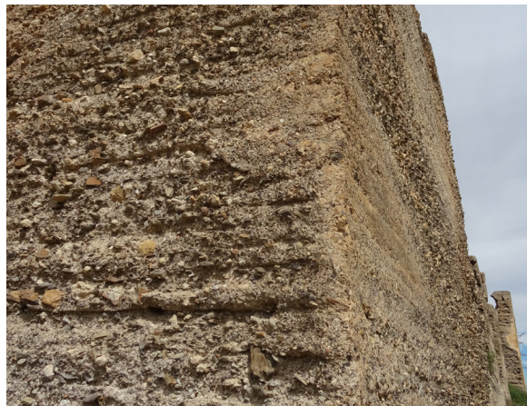
FIG. 40. Torre 8. El desprendimiento de costra y los efectos de la erosión se muestran bastante bien en esta imagen. En la esquina y cara de la torre aún se conservan pequeñas porciones de costra, aunque bastante deterioradas.
