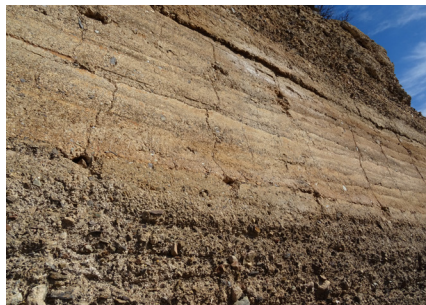
FIG. 9. Desprendimiento de la costra de las fábricas de tapia del Castillejo.
