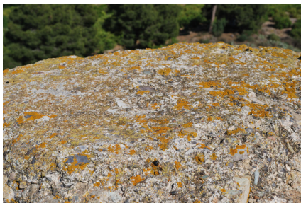
FIG. 8. Bideterioros y presencia de líquenes sobre la coronación de la torre 10.
