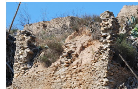
FIG. 20. Coronaciones inestables con peligro de desprendimiento en la torre 22.
