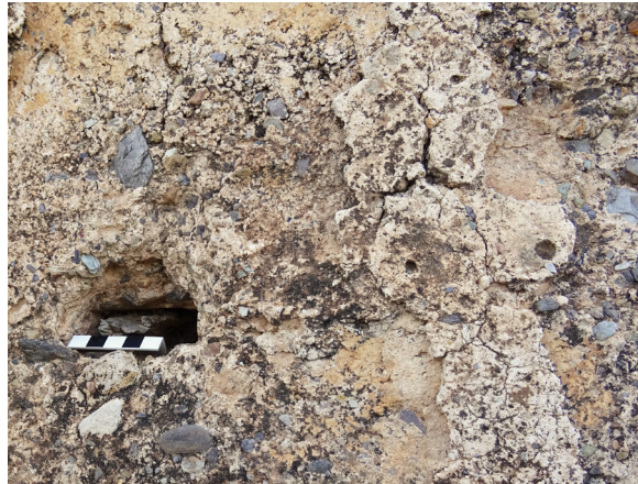
FIG. 63. Torre 1. El envejecimiento, la alteración biológica y la erosión son otros de los factores que originan el cuarteado de revestimientos. En la imagen se observa el cuarteado y el desconchado de la capa de acabado.
