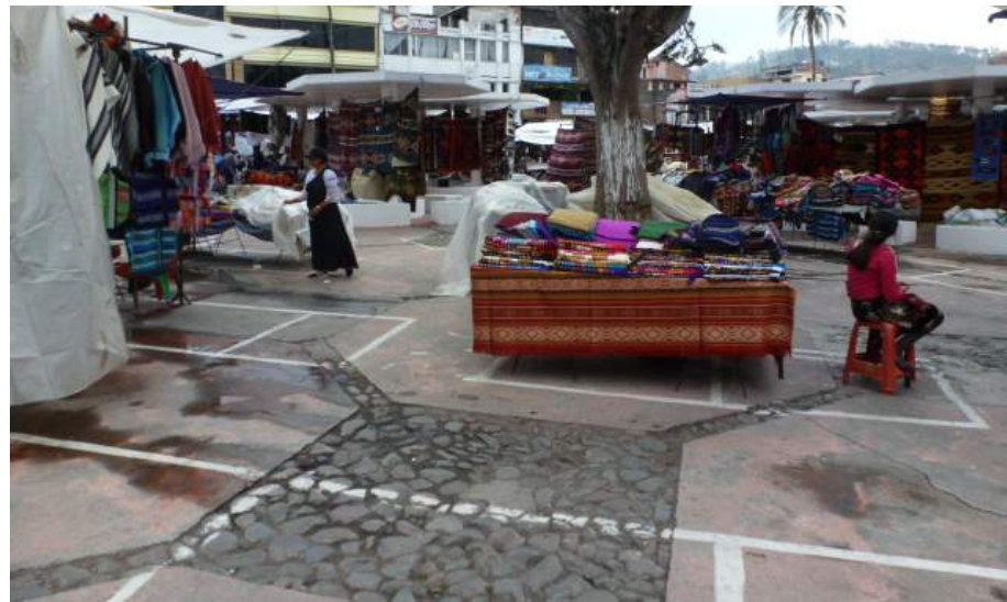
Imagen 50, 51 y 52: Estado de los pavimentos
