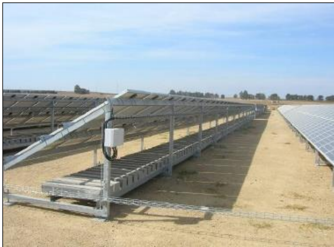
Ilustración 11. Imagen de una instalación fotovoltaica estática
