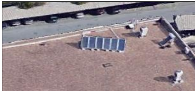
Ilustración 7. Instalación solar térmica
