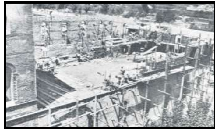
Fotografía Histórica 12.-.- Colocación estructura auxiliar para construcción de sobreelevación de los pabellones del Colegio San José. Revista Auras agosto 1920.pág. 296
