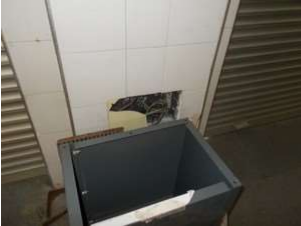
Riesgo 12: Rotura de tapa de caja de conexiones.
