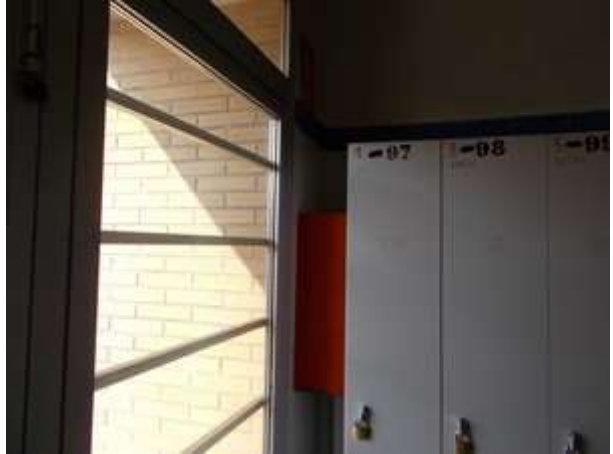
Riesgo 18: Extintor no accesible.
