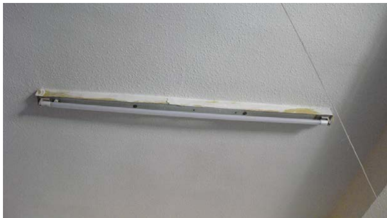
Figura 22 Ejemplo de techo y luminaria. Fuente: propia.
