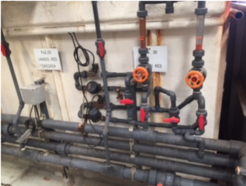
Figura 10: una muestra de la gran cantidad de tuberías que hay en la planta
