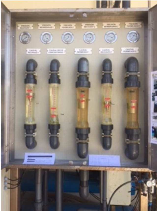
Figura 17 caudalímetros de la osmosis inversa de la planta en funcionamiento
