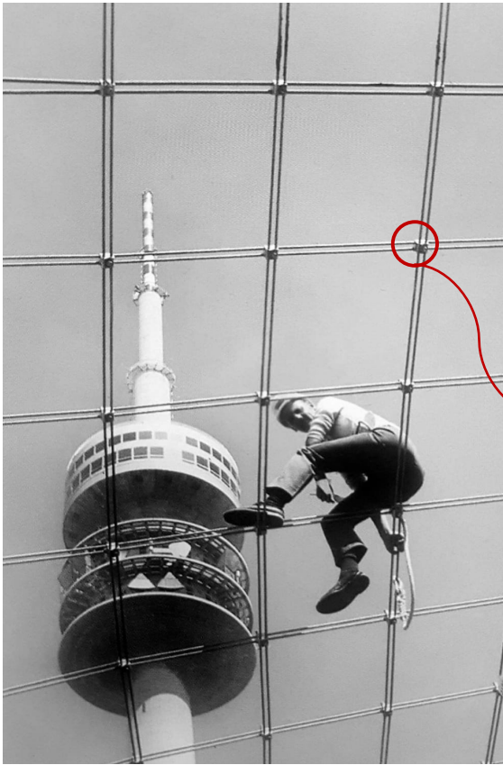
Fig. 53 Red de cables sin cubrición
