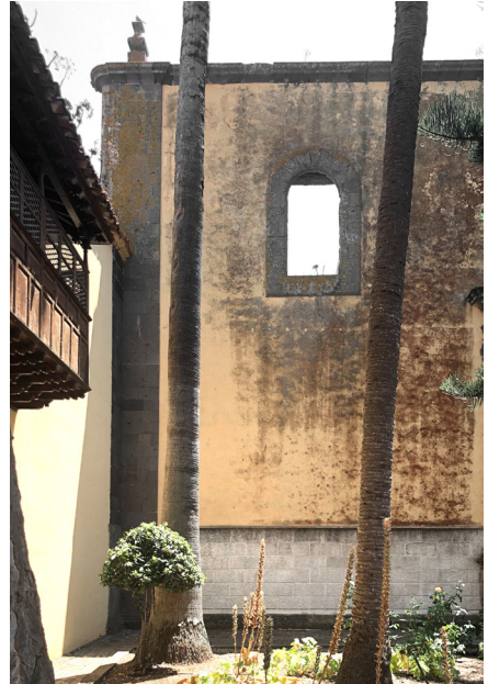
Figura 4.7. Colonización vegetal en la fachada norte (Elaboración propia, 2018)
