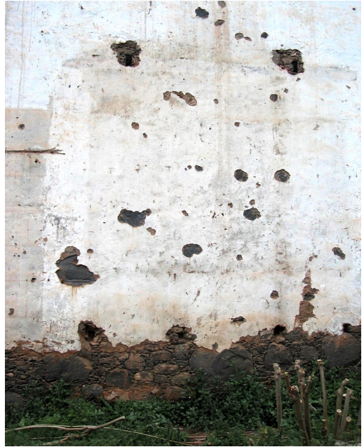
Figura 4.11. Muros de mampostería, pérdida de revestimiento (Autor: Lorenzo Santana, 2008)
