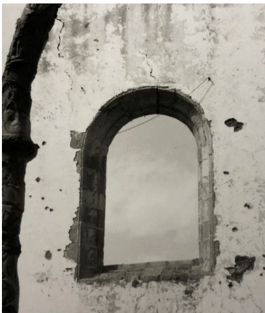
Figura 4.9. Grietas visibles en los huecos (Autor: Javier Martínez, 1998)
