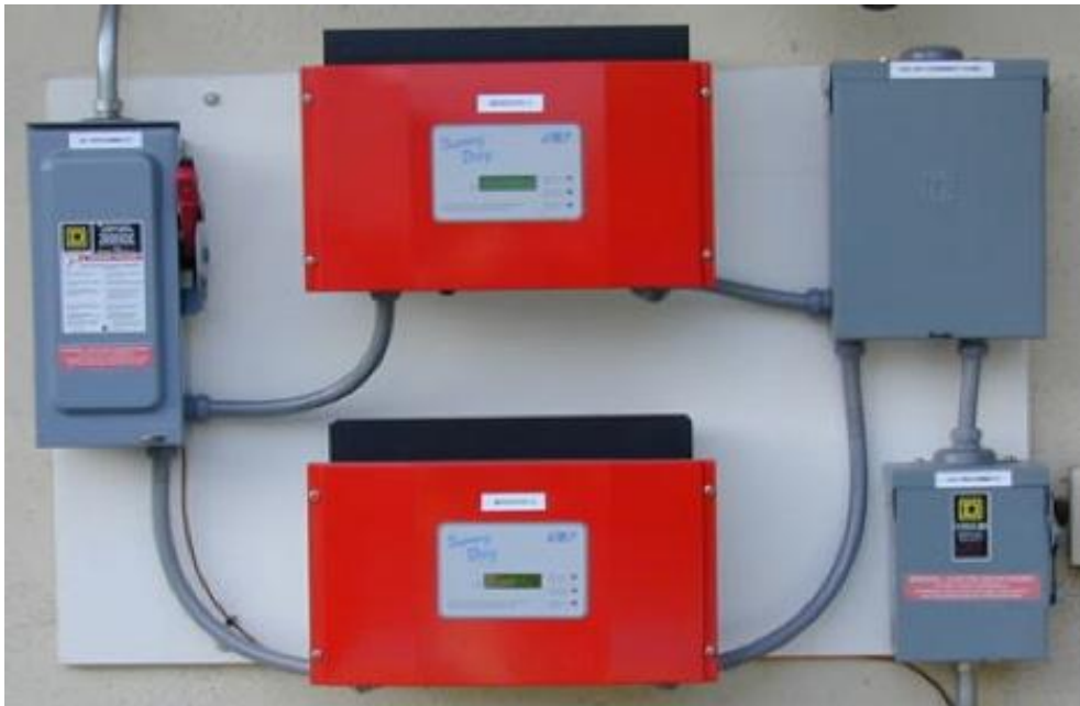
Figura 11. Inversores de corriente y protecciones.
