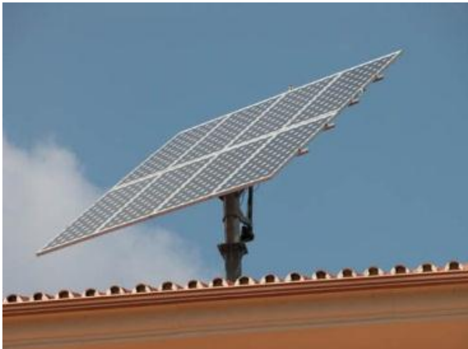
Figura 13. Seguidor solar instalado en tejado.
