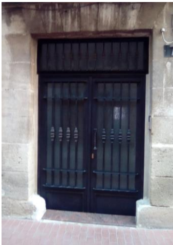
● Figura 109. Puerta metálica impropia de la arquitectura tradicional
