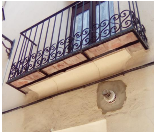
Figuras 58 y 59. Refuerzos de la sujeción de los balcones en la parte inferior de los voladizos
