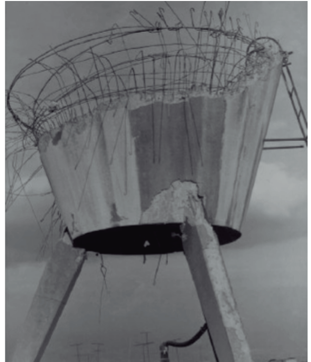
Figura .46. Imagen de la copa de agua del bloque B después del terremoto.
