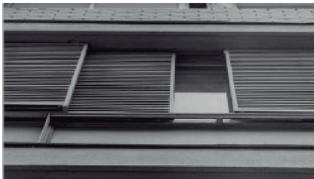
Figura .34. Imágen de las correderas metálicas de fachada del bloque A.
