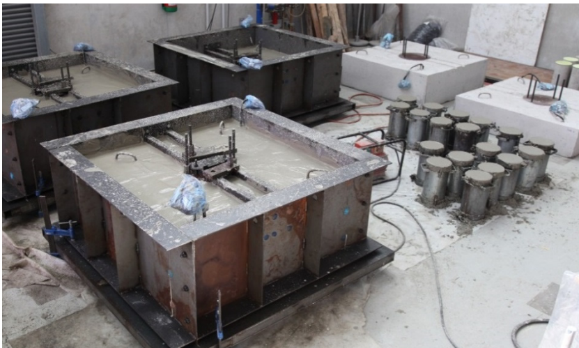
Figura 3.14 Encepados de cuatro pilotes recién hormigonados junto con las 18 probetas de control y piezas acopiadas
