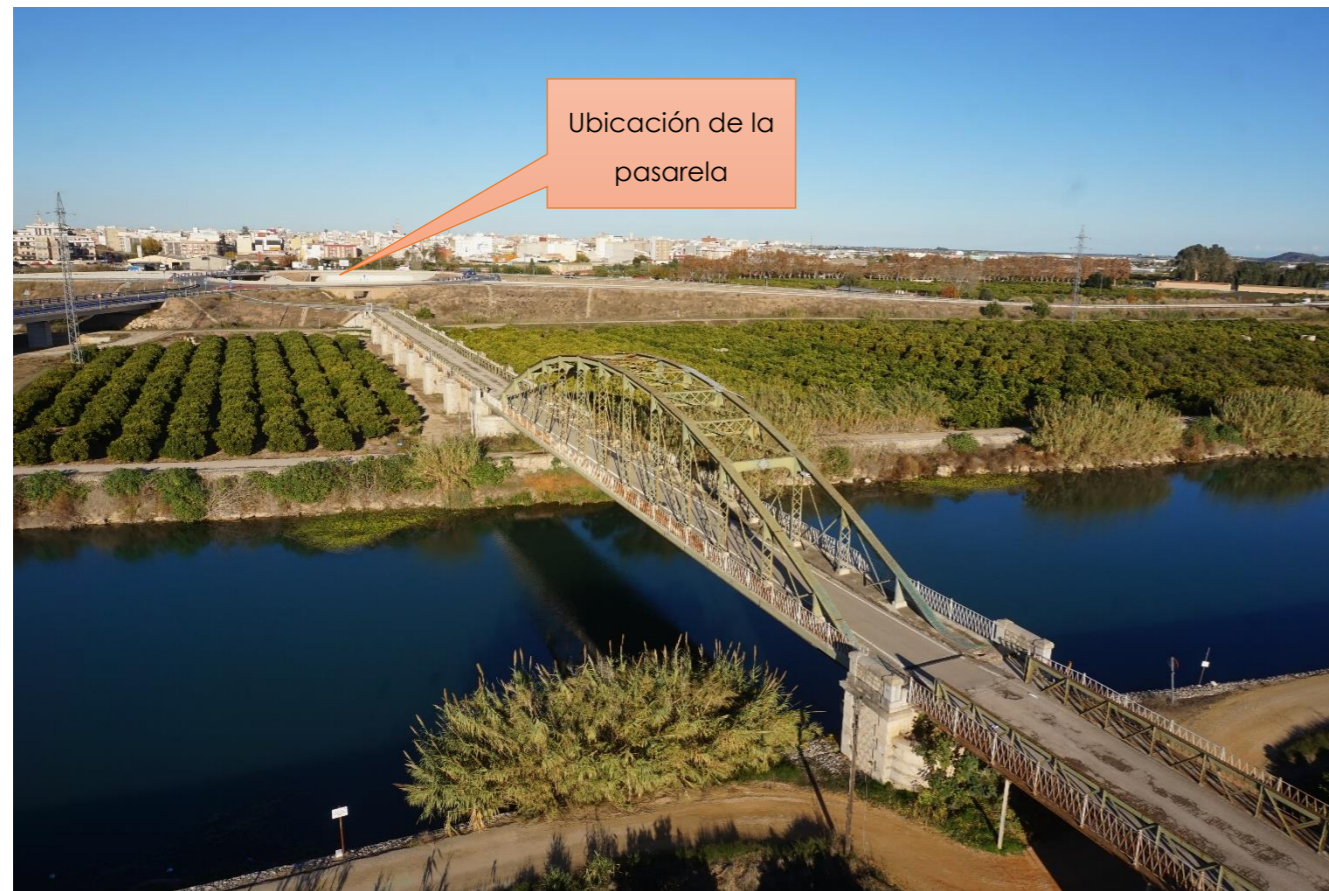
Figura 1 Puente de Alfonso XIII antes de la rehabilitación. Fuente: Dron PAVASAL
