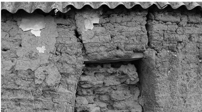
[Fig.38] Grietas en el alzado sur. Fuente: Cristina Ramos Furió
