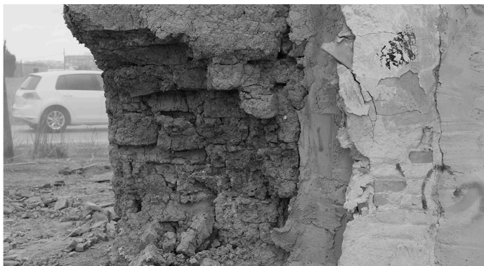
[Fig.35] Erosión del muro en el alzado este. Fuente: Cristina Ramos Furió
